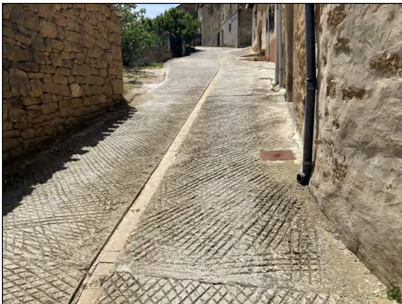
Tramo tras el encuentro con la calle Guiriria. Hormigón rayado en mal estado, con caz de piezas prefabricadas.
