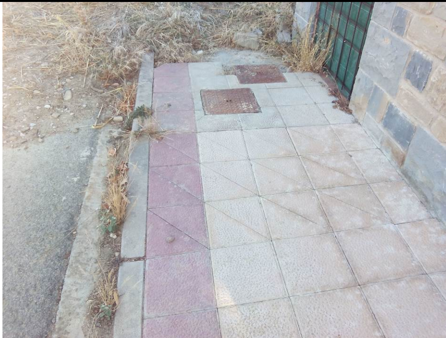
1. Conexión sur a urbanización existente. Arquetas de servicios.
