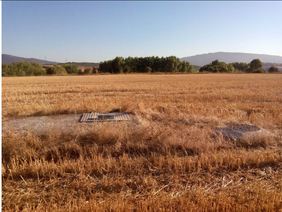
3. Arqueta sur de abastecimiento.
