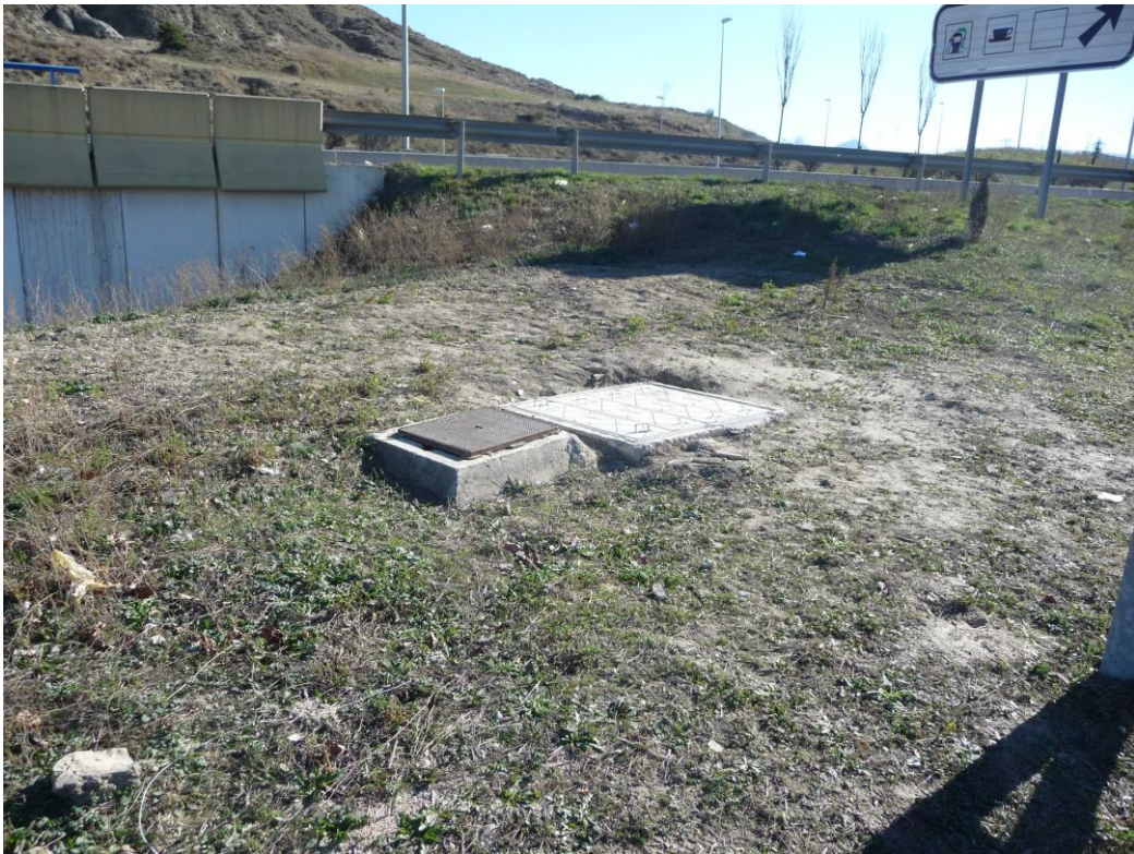
Arqueta de teléfonos entre ramal y calzada Ronda Este
