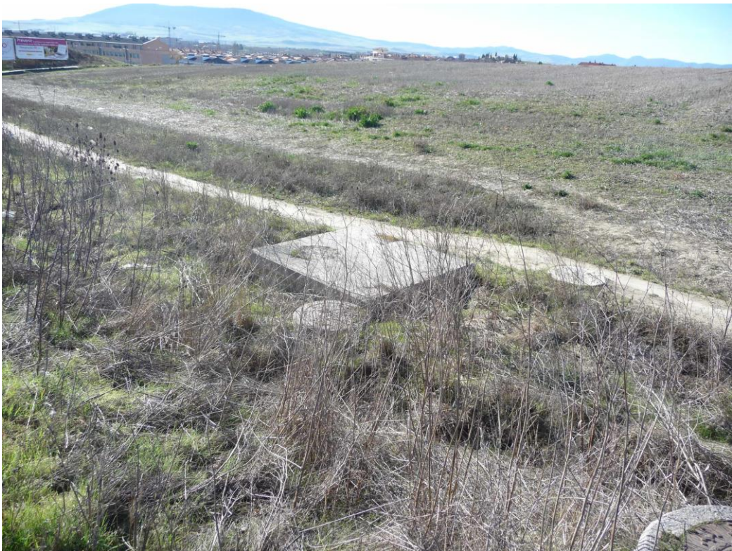
Arqueta de desagüe
