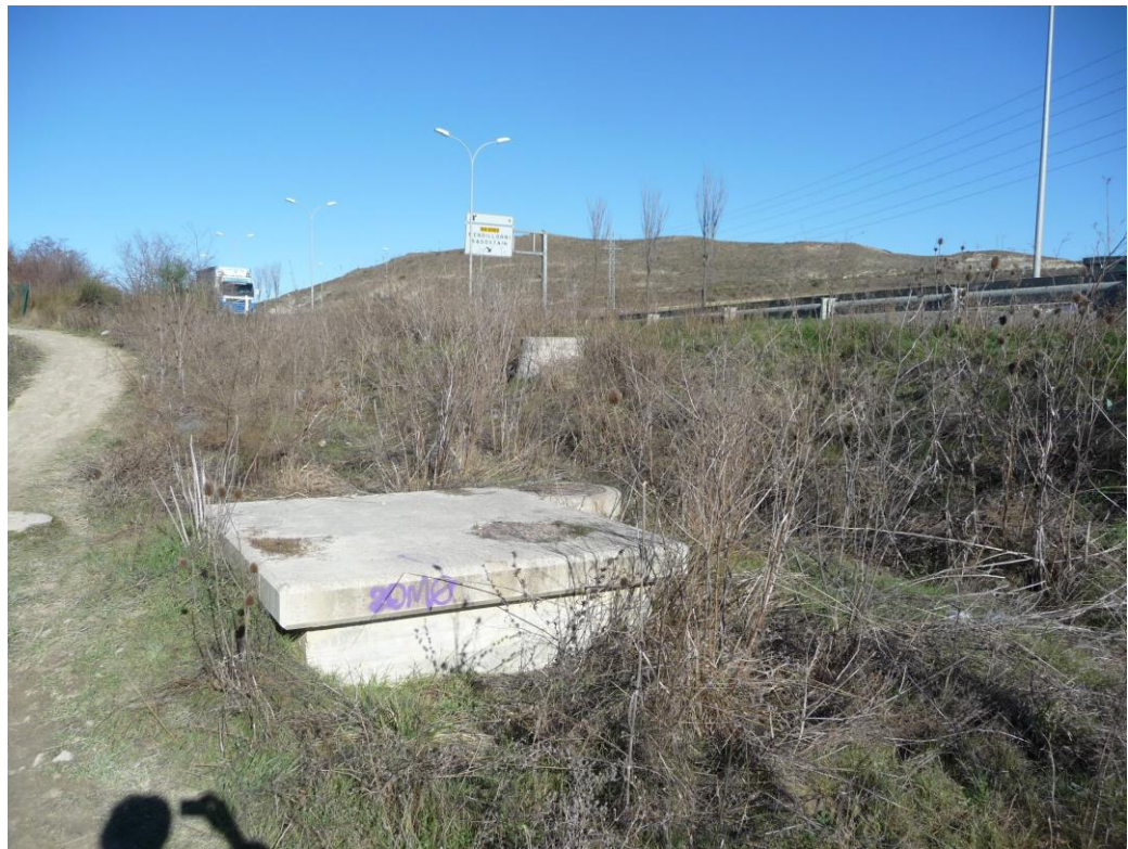
Cota de la arqueta más baja que la calzada de la Ronda Este
