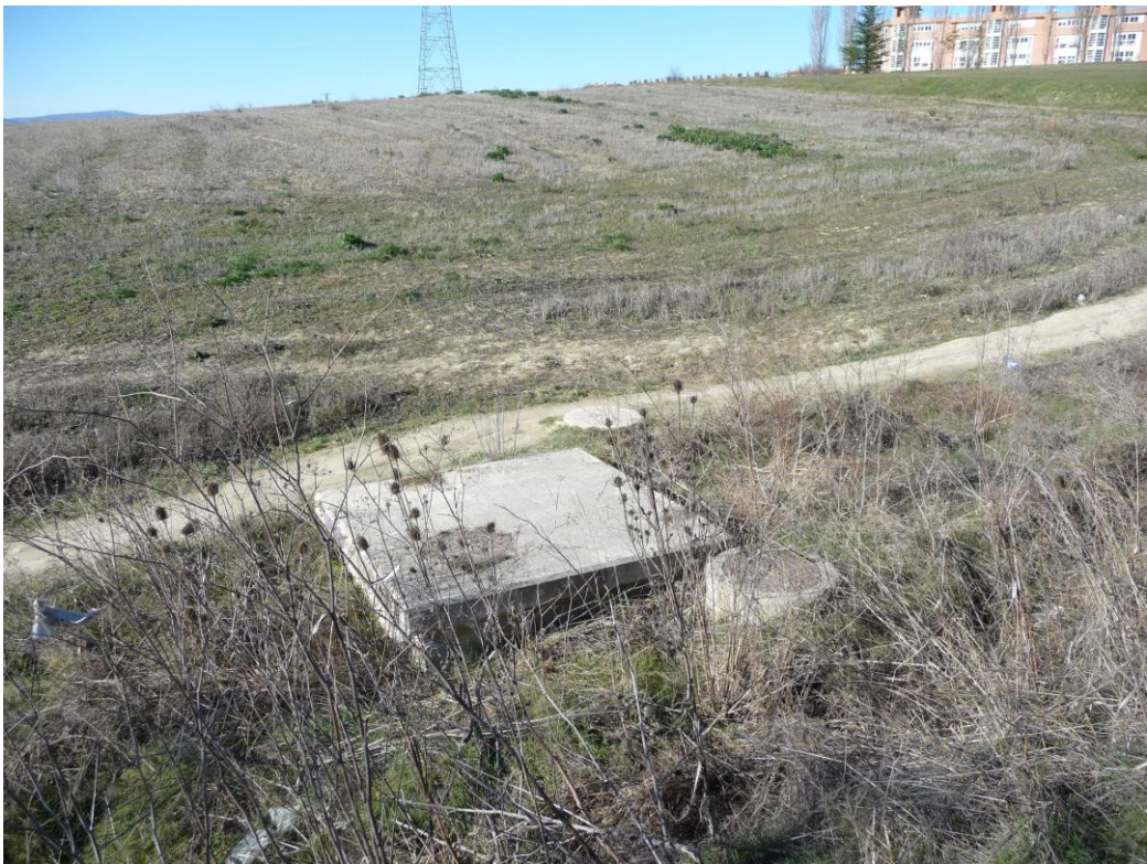
Arqueta de desagüe y tapa del marco
