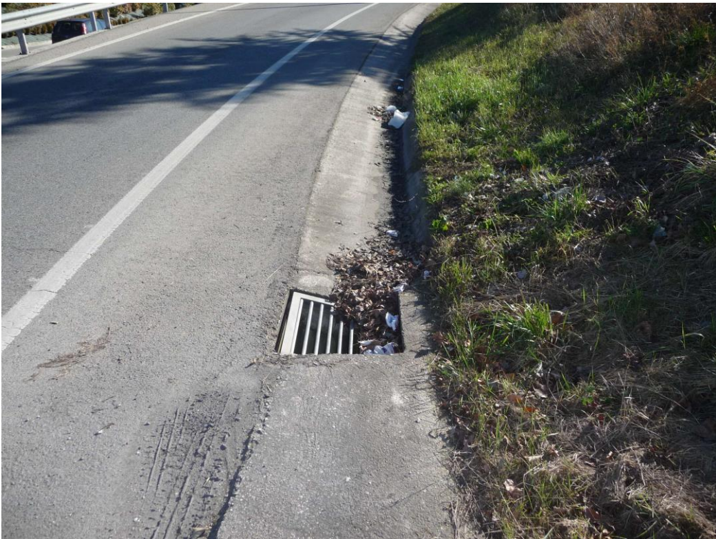
Rejilla al comienzo del ramal de Mendillorri
