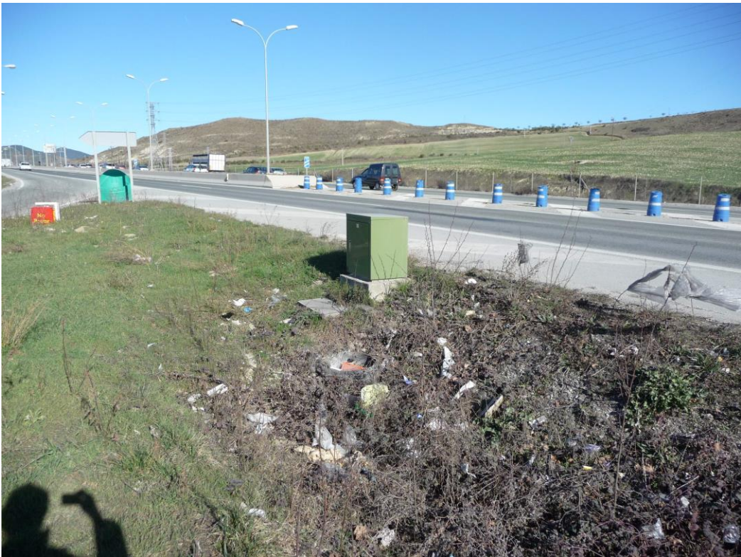
Instalación de Aforo
