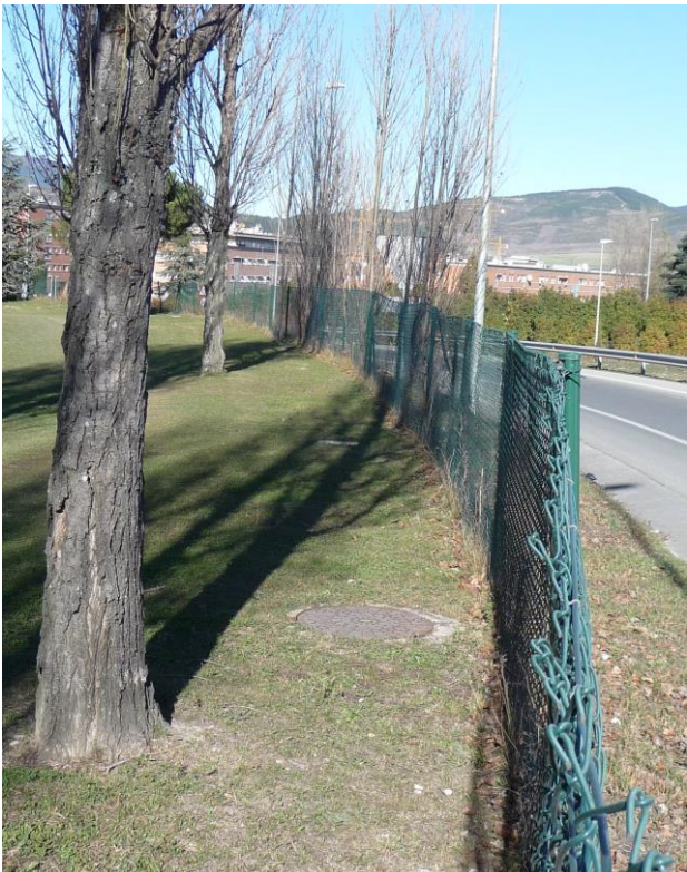
Arqueta de pluviales. Pk 6+065
