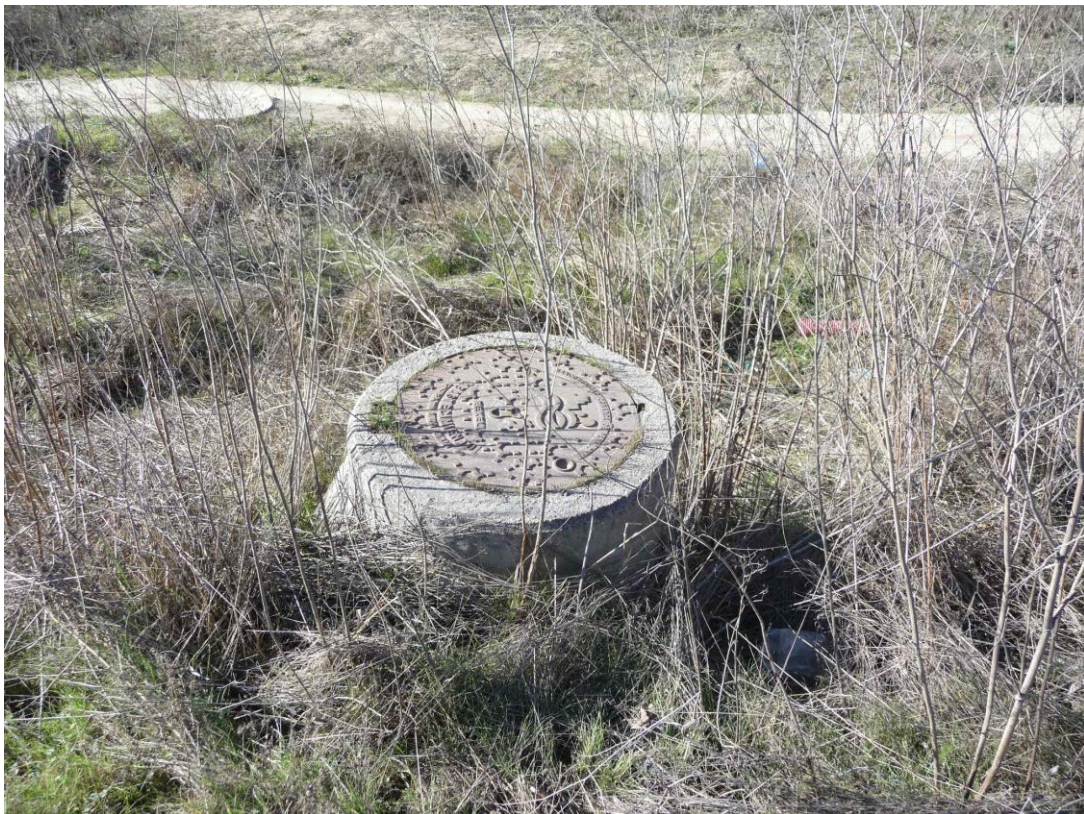
Arqueta existente ACPSA
