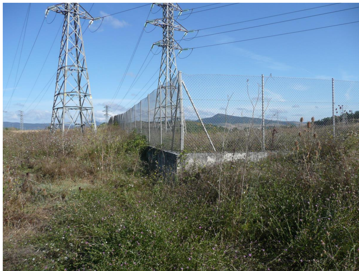
Se observa un la esquina de un cerramiento afectado por las obras
