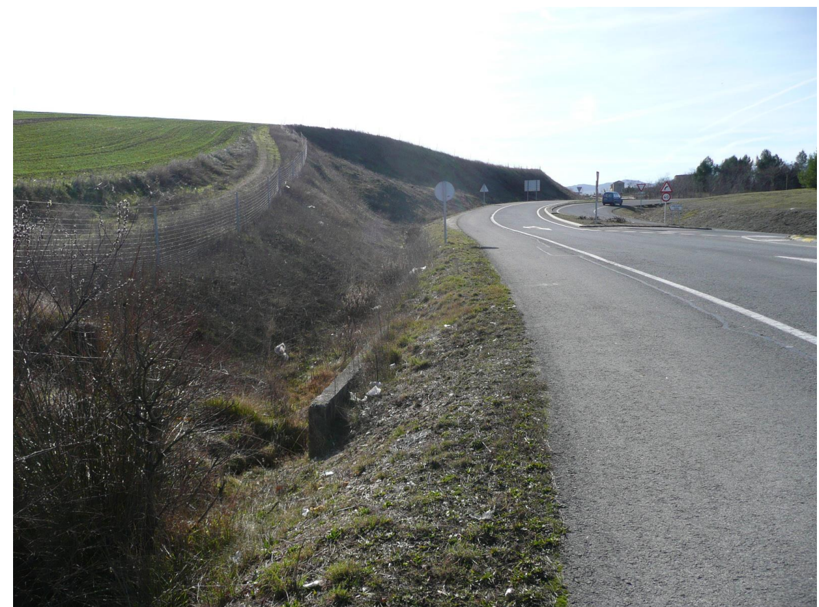
O.F. existente de desagüe tanto de la crta NA-700 como del vial de salida de la Ronda Oeste
