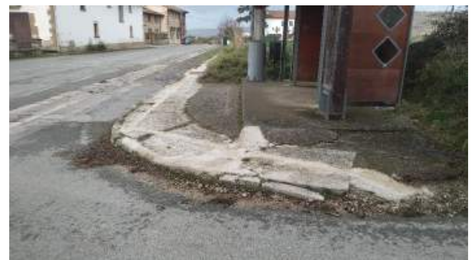
Figura 37. Travesía Monreal. Parada de Bus. Roza canalización telecomunicaciones
