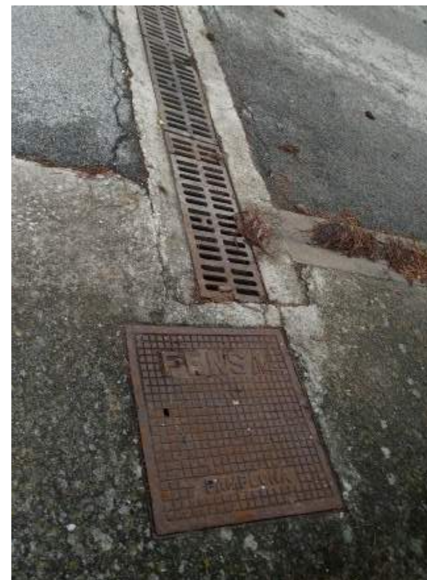
Figura 15. NA-2420. Acceso a calle Alzórriz. Arqueta de electricidad
