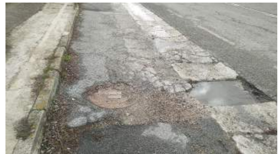
Figura 35. NA-2420. Travesía Monreal. Parada de Bus. Arqueta Iberdrola
