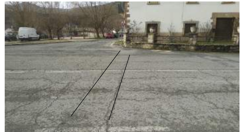
Figura 36. Travesía Monreal. Parada de Bus. Roza canalización eléctrica
