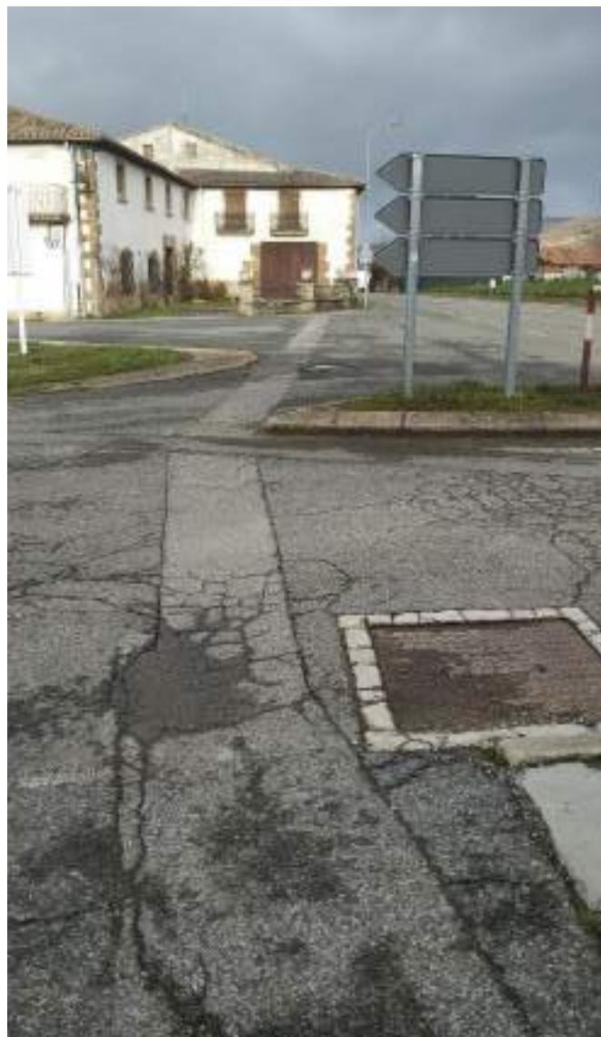
Figura 17. NA-2420. Intersección acceso a Monreal. Roza de canalización eléctrica
