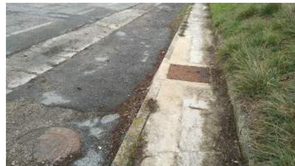
Figura 41. Travesía Monreal. Parada de Bus. Registros de electricidad y telecomunicaciones
