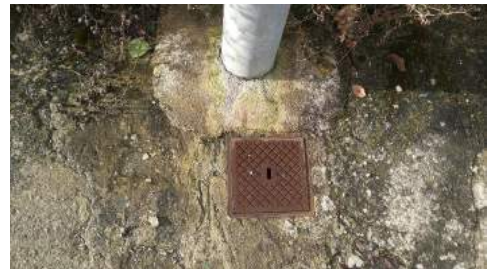
Figura 4. NA-2420. Acceso desde Jaca. Arqueta pie de luminaria
