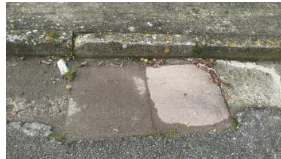
Figura 9. NA-2420. Acceso desde Jaca. Arqueta de servicios desconocida
