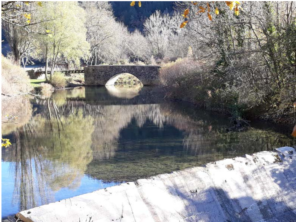
Detalle de presa con el trasdós colmatado
