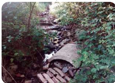
Fot. 5.31: Restos del tubo prolongación ODT
