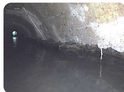
Fot. 5.16: Desaparición hastiales MI Boca Sur
