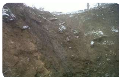
Fot. 5.26: Talud a. abajo Boca sur de la ODT tras el deslizamiento de 2015
