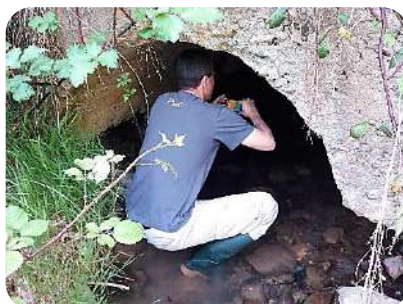
Fot. 5.12: Capacidad hidráulica afectada por acarreo y erosión en hastiales salida ODT
