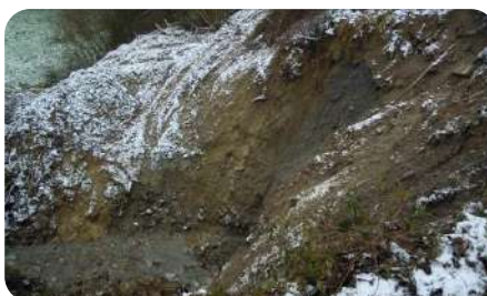
F5: Deslizamiento talud a. abajo ODT 2013-2015
