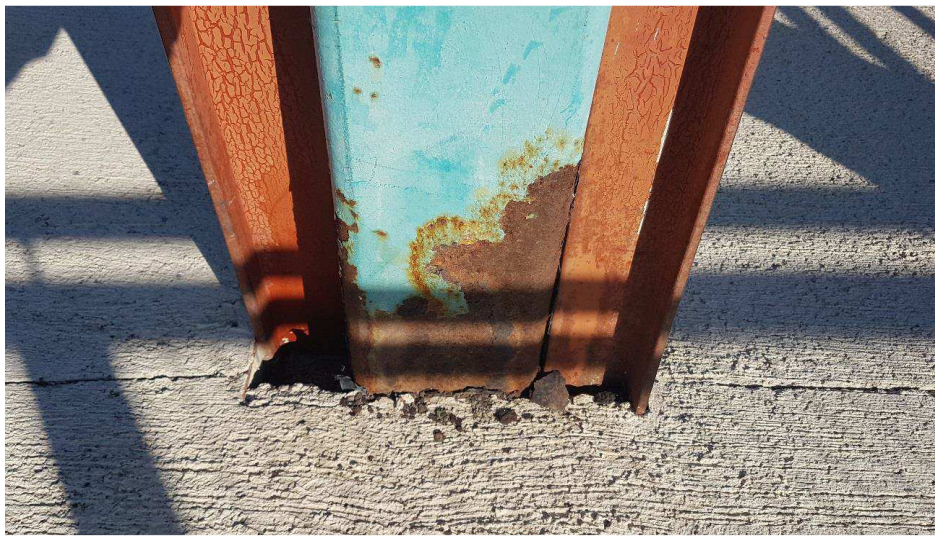
Diversos puntos con oxidación
