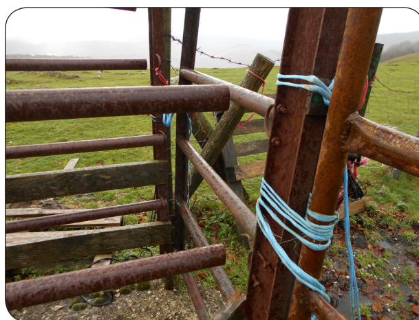
Detalle de los montantes de puerta, en el que se ven las barras horizontales sueltas.
