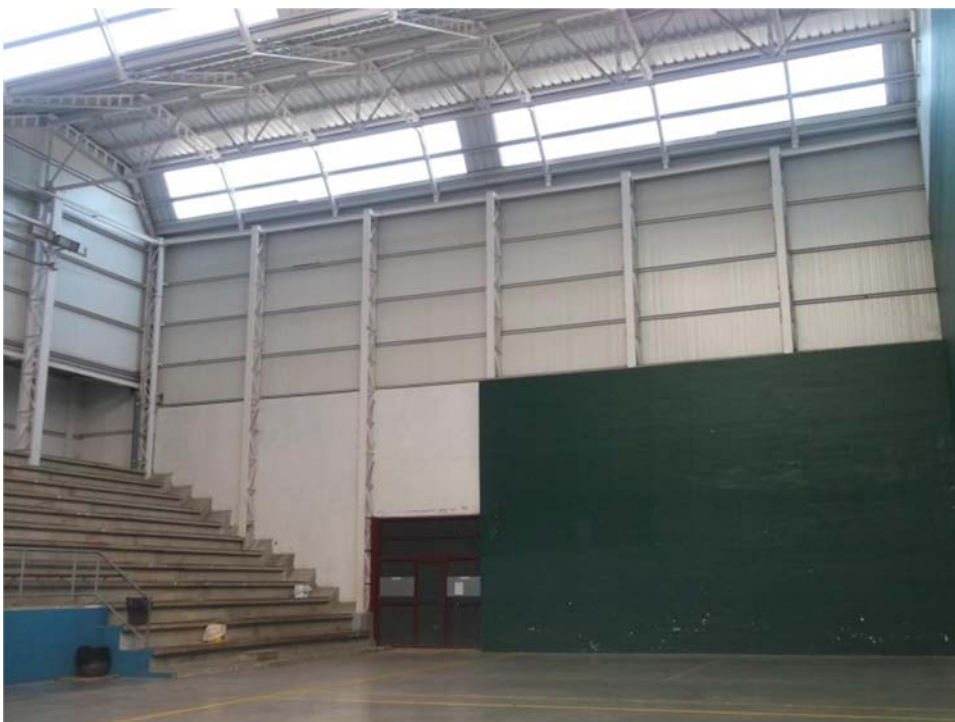
Sin señalizaciones de salida ni extintores ni iluminación de emergencia.
