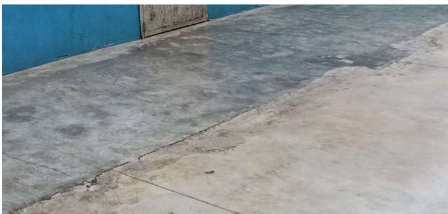
Suelo zona juego deteriorado
