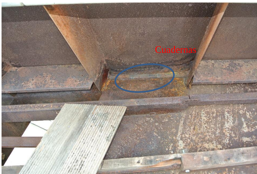
Detalle de corrosión en el cordón inferior y en el alma de las vigas laterales
