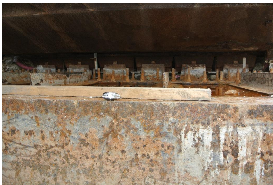
Corrosión en rótulas de apoyo en estribo Jito Alai
