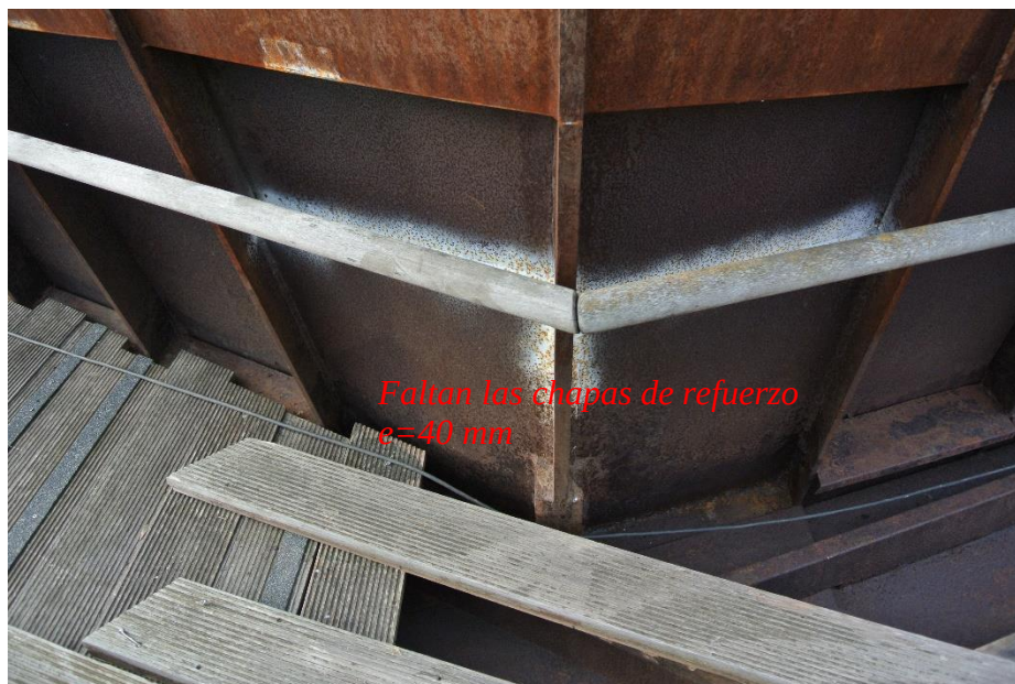
Detalle del refuerzo contemplado en el modelo de Proyecto no colocado en obra
