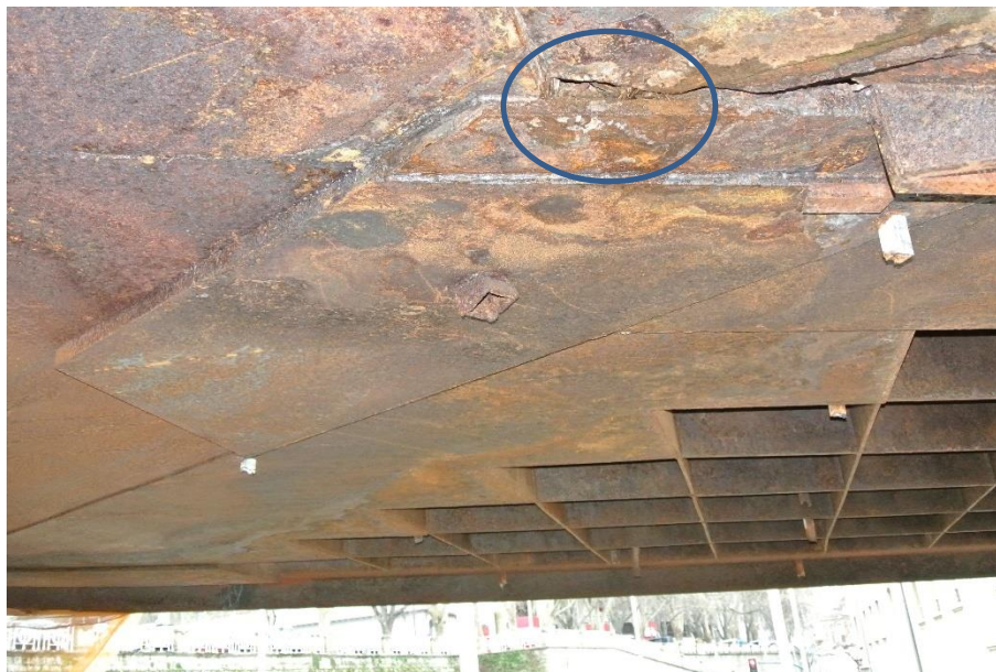
Detalle de corrosión en chapas inferiores del nudo
