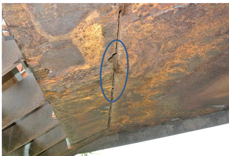
Detalle de separación entre el cajón de la escalera y el nudo
