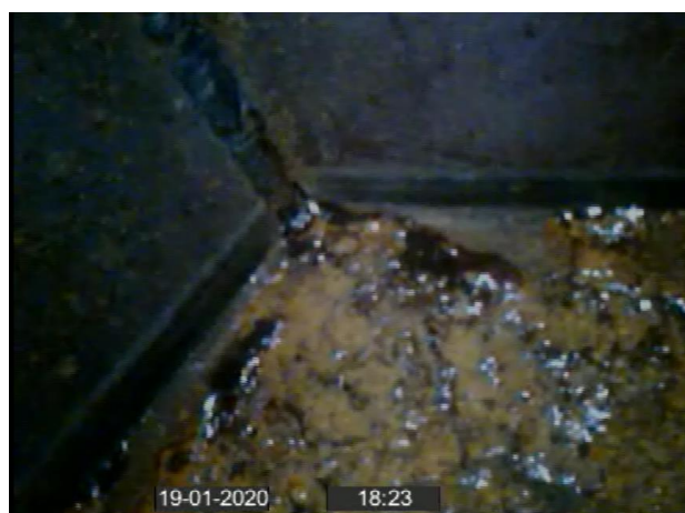
Escalera de acceso lado Labrit. Corrosión más profunda y picaduras en cordón inferior
