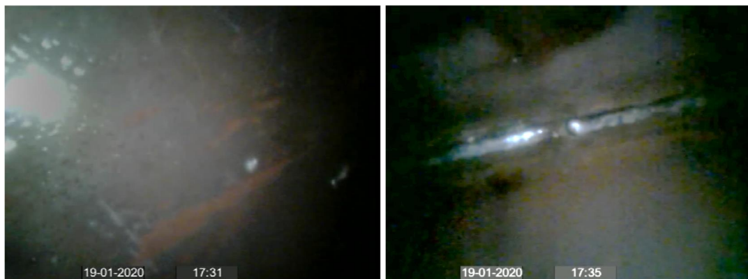
Corrosión muy superficial en la chapa inferior. Soldadura con defecto puntual.
