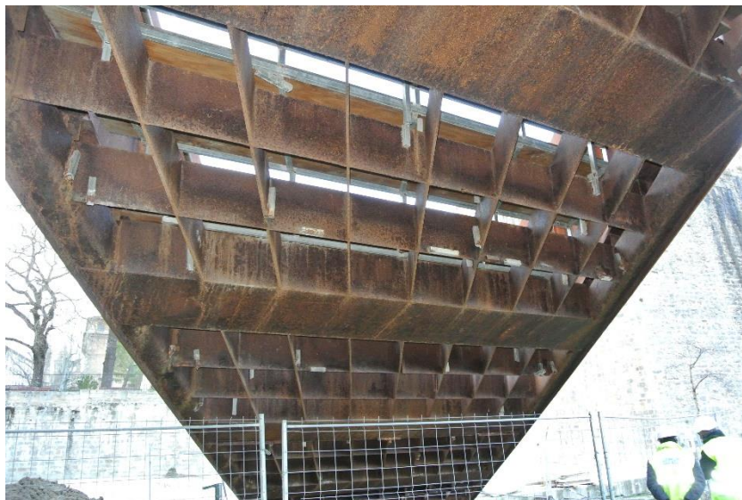
Detalle de corrosión en la unión de chapas con el cordón inferior, uniones soldadas mal ejecutadas
