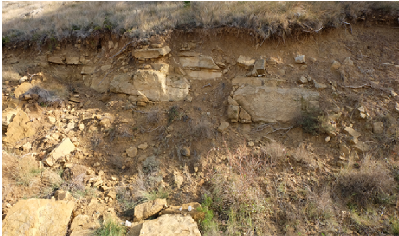
Fotografía: Detalles de macizo rocoso alterado por la inestabilidad
