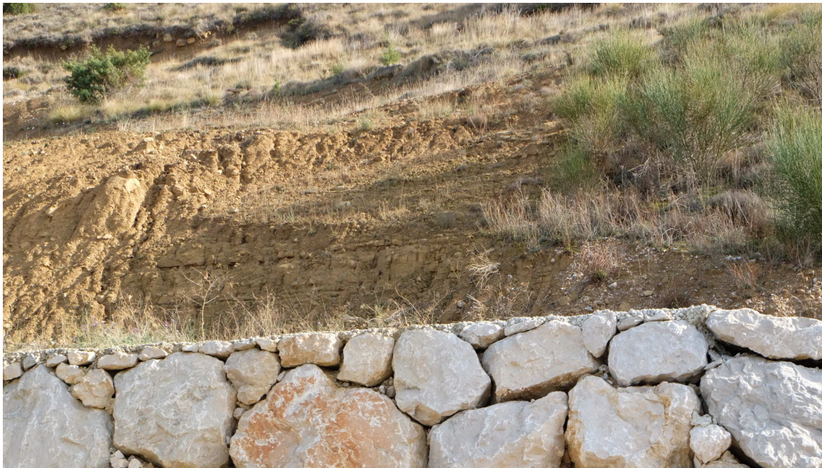
Fotografía: Aspecto de inestabilidades locales sobre la escollera.
