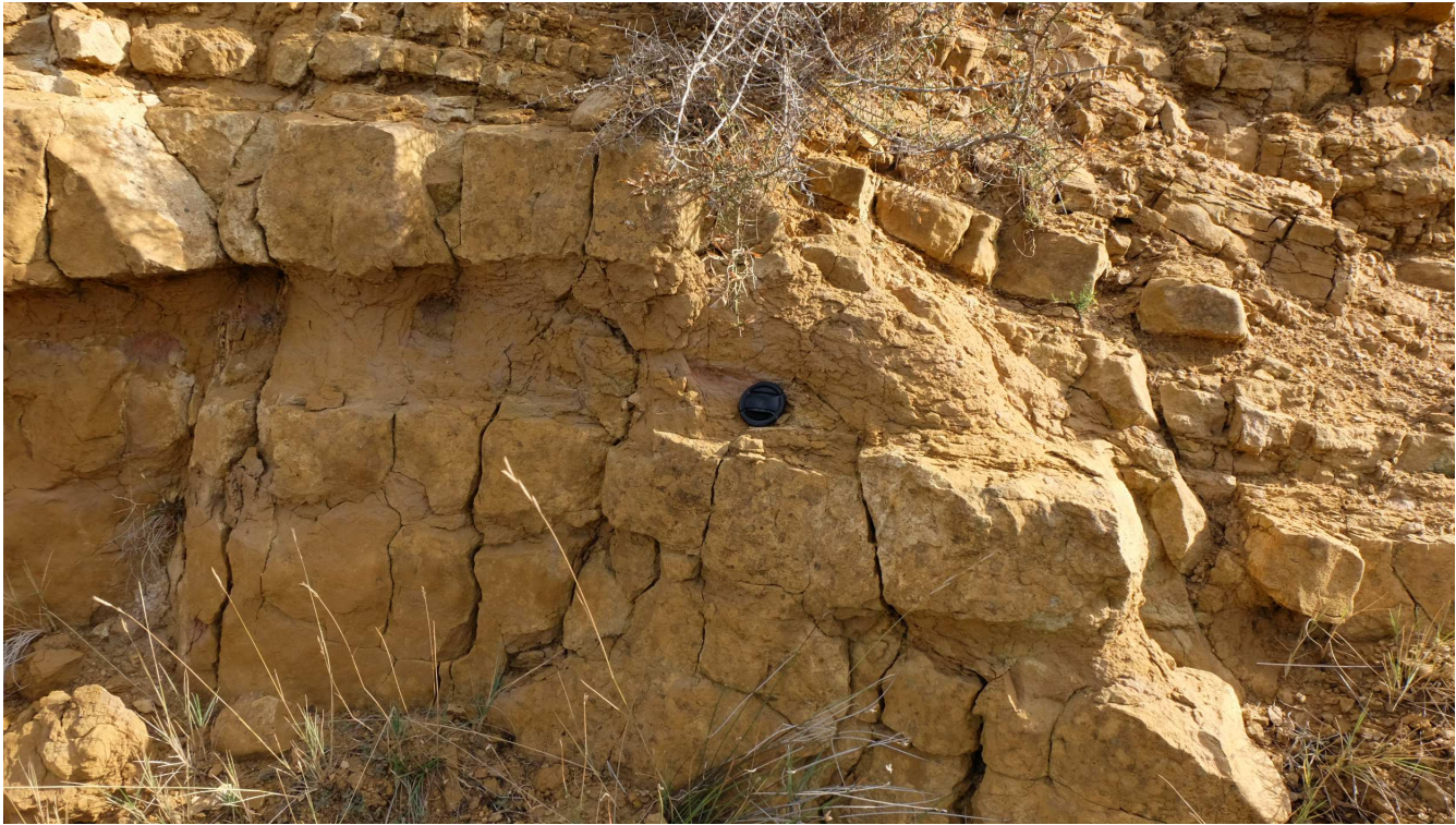
Fotografía; aspecto del macizo rocoso alterado.
