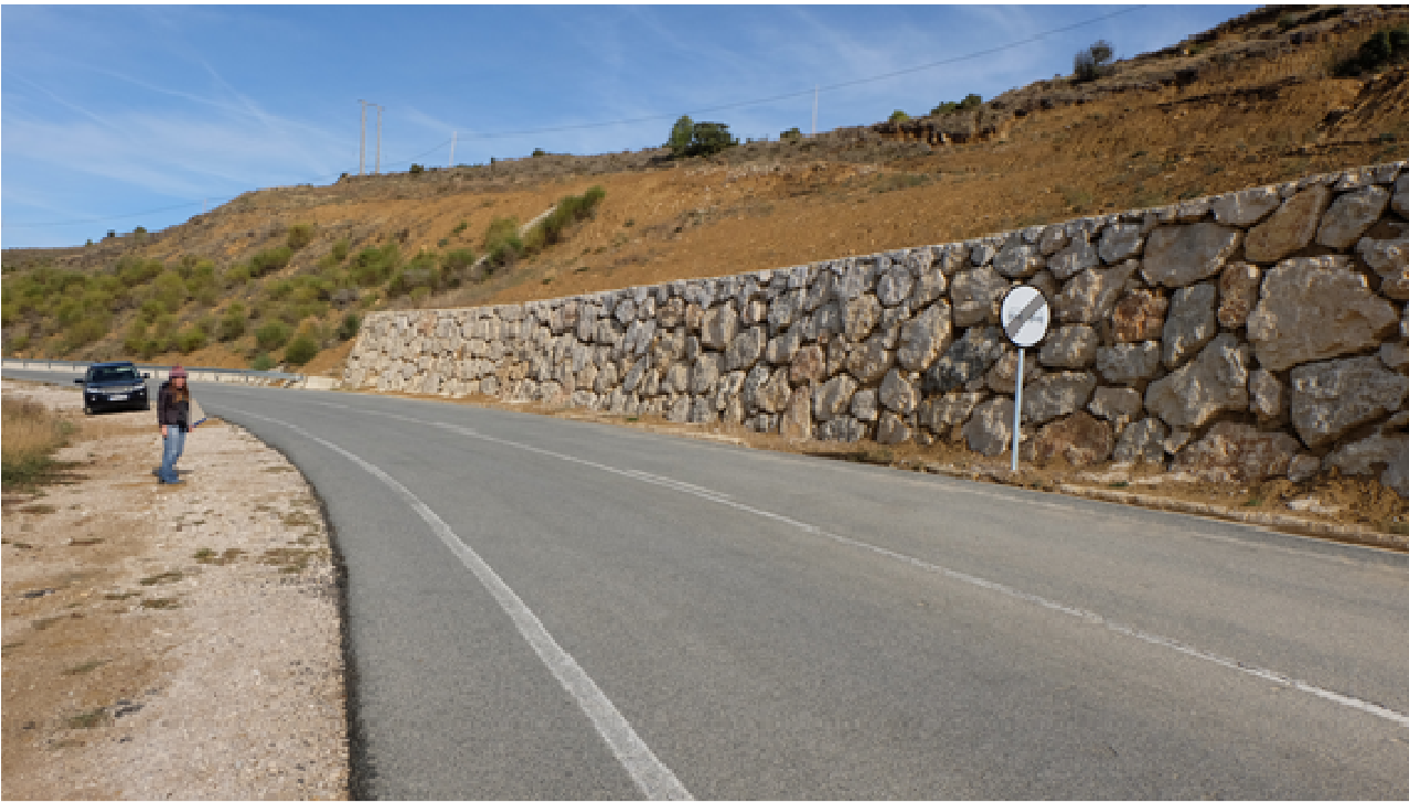
Fotografía: Escollera localizada al pie de la zona deslizada.
