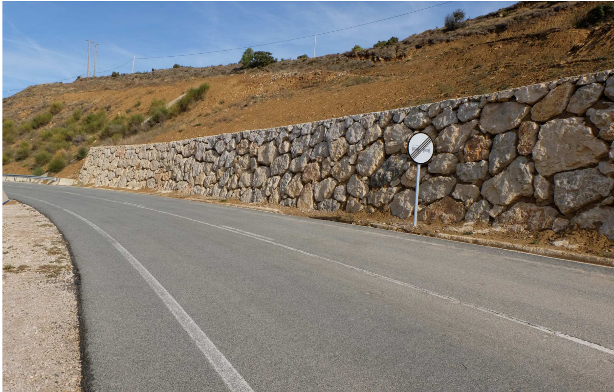
Imagen 5. Se observa la escollera con el talud inferior afectado por la erosión.
