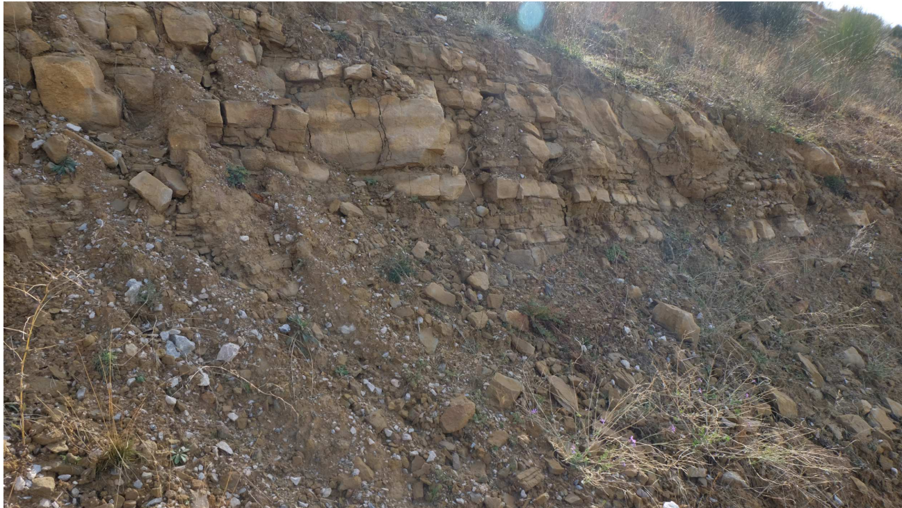
Imagen 1. Aspecto en afloramiento del macizo rocoso alterado
