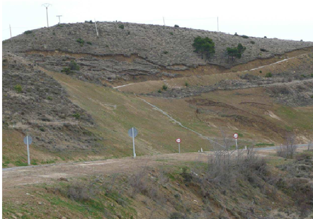
Fotografía del talud tomada el 5/2/2009 en la que ya se observa la presencia de dos deslizamientos superficiales en la parte baja del talud y una gran grieta de tracción en la cabecera.
