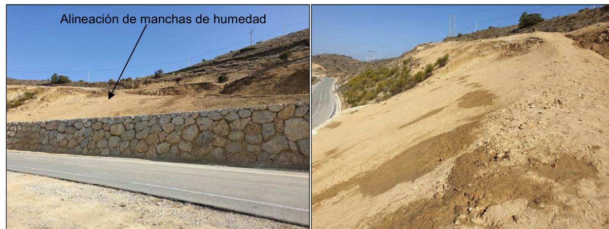
Vista desde la carretera y los caminos de acceso de la alineación de manchas de humedad observada en el talud tras las lluvias.
