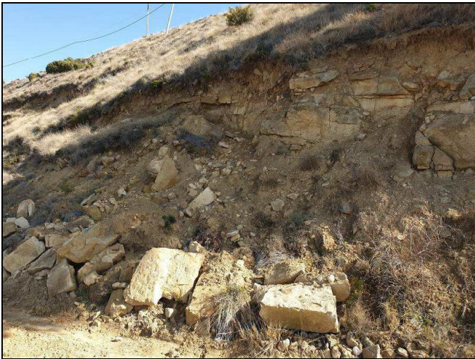
Fotografía del escarpe existente en la coronación del área desplazada en la que se observa el afloramiento de las areniscas y cómo estas presentan un plano o “cara” vertical que ha condicionado el rumbo del plano de rotura o deslizamiento.
