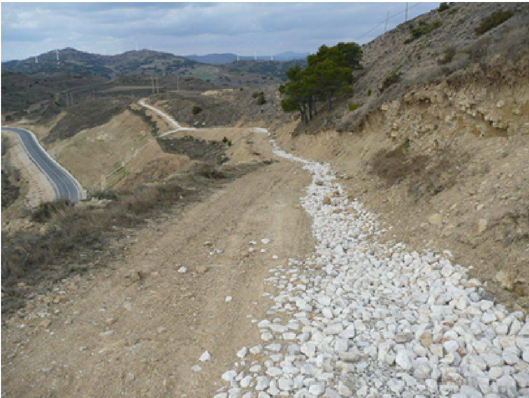
Fotografía de la cabecera del talud tomada el 3/3/2009 en la que se aprecia claramente el drenaje construido en la parte interna del camino al cementerio que discurre por la cabecera del talud.
