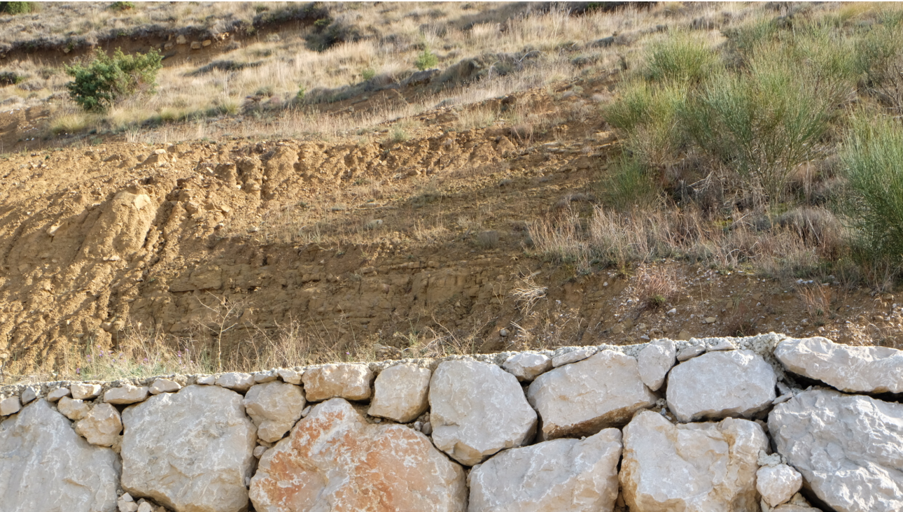
Aspecto de inestabilidades locales sobre la escollera.
