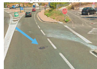
Ramal A-12 - A-15 (marg.dcha). Cambiar tapa (1 pluviales)
