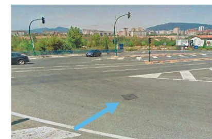
Calzada A-12 límite estructura (margen derecha). Cambiar tapa (1 indeterminado)
