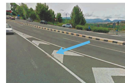
Ramal A-12 - A-15 (marg.dcha). Cambiar tapa (1 pluviales)
