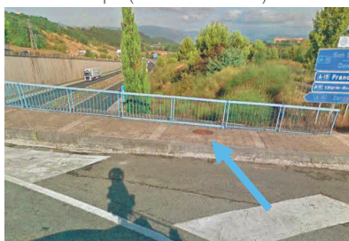
Acera A-12 sobre estructura (margen izquierda). Cambiar tapa (1 telefónica)
