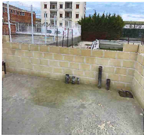
CASETA DEPURACION Y BOMBAS
