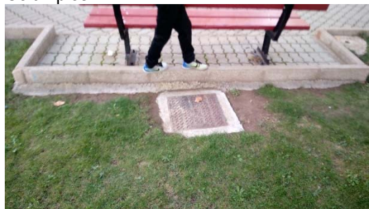
Arquetas eléctricas tras bancos
