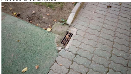
Desagües de pasillos taponados
