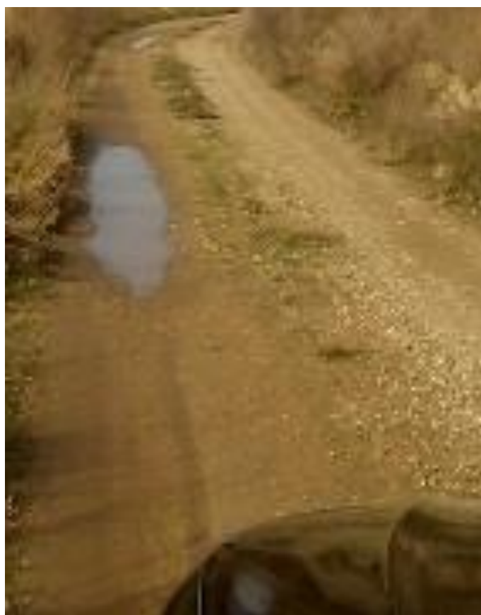
Bacheado y afección en capa de rodadura en camino de tierra; estado actual
