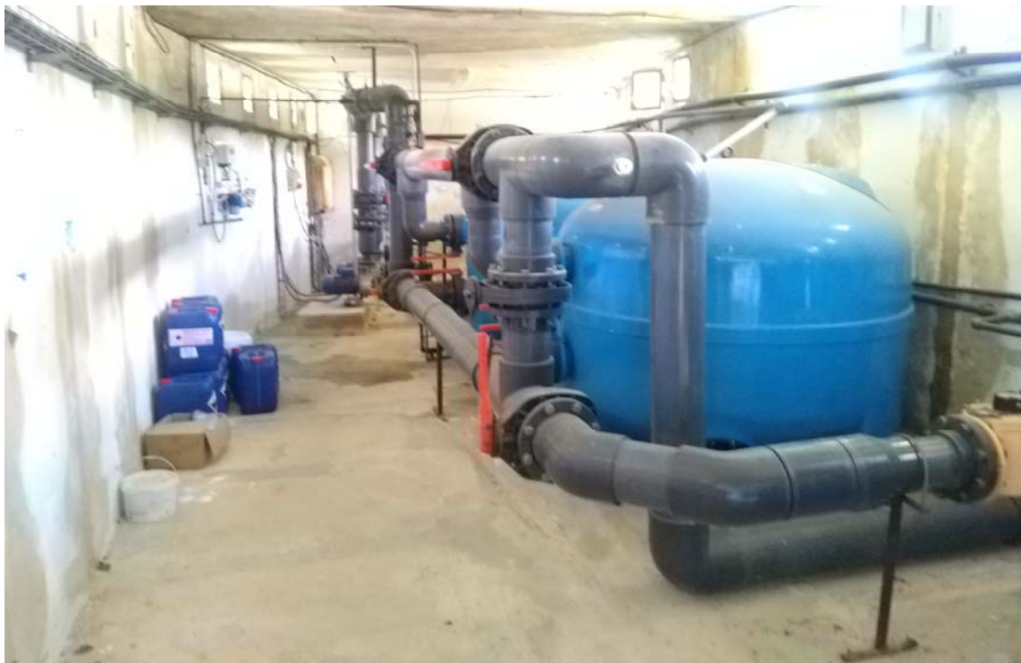
Bombeo y depuración de la piscina olímpica.
