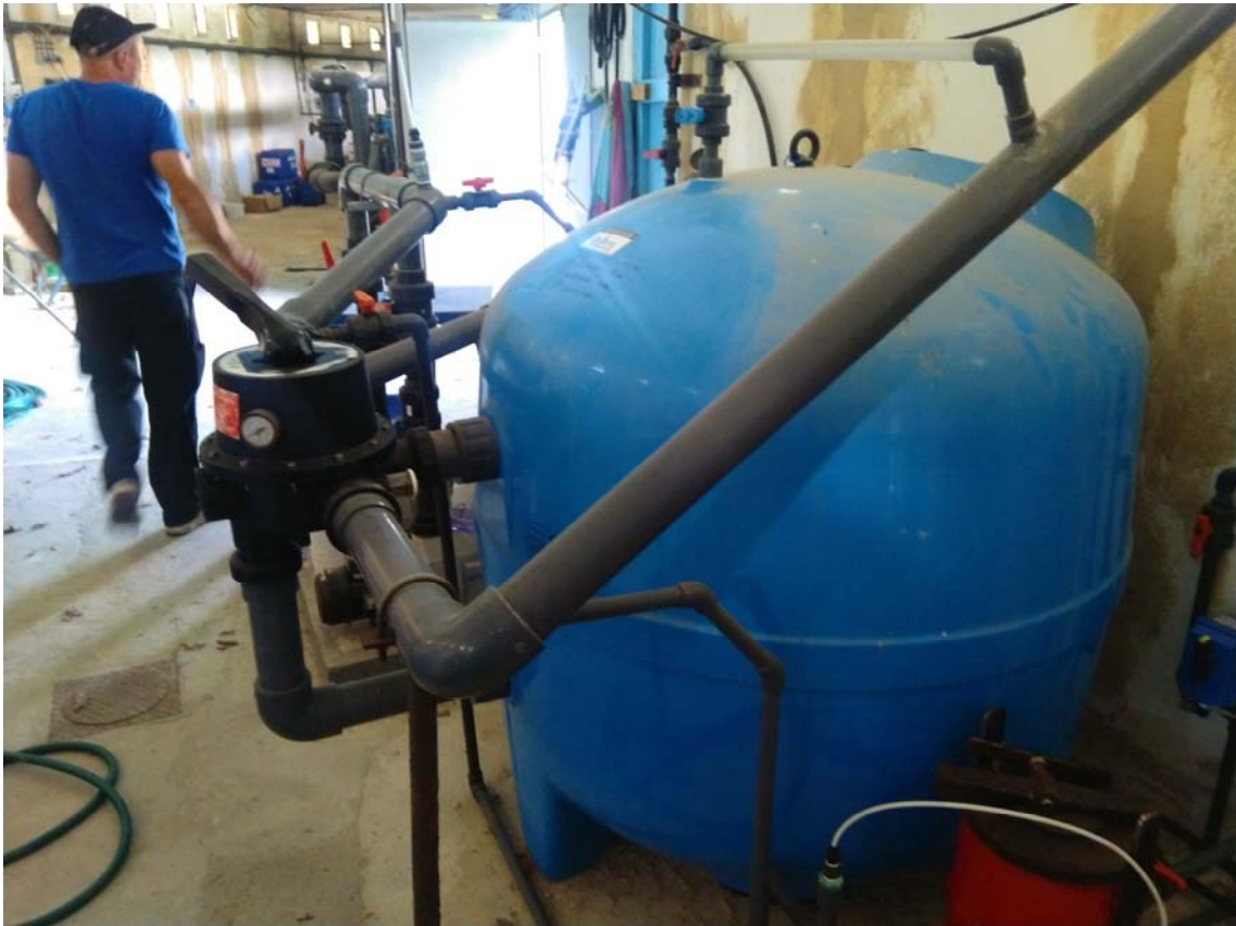
Bombeo y depuración de la piscina de recreo.
