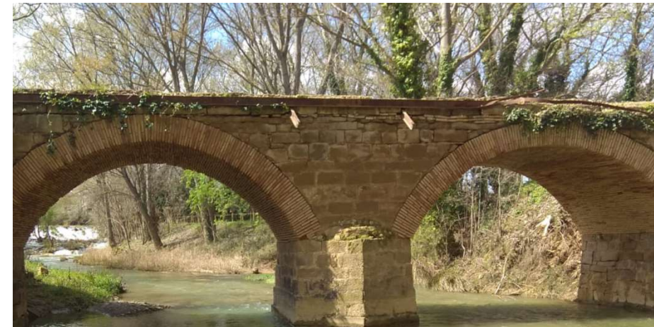
Figura 6 - Pérdida de material de junta en piezas de sillería de los tímpanos
