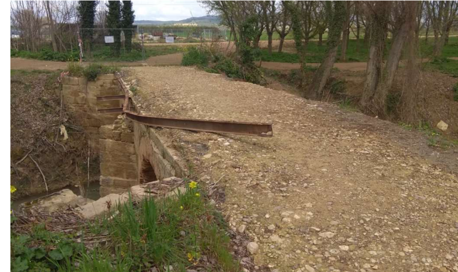
Figura 1 - Restos de la estructura metálica para paso de peatones. Vista desde uno de los estribos
