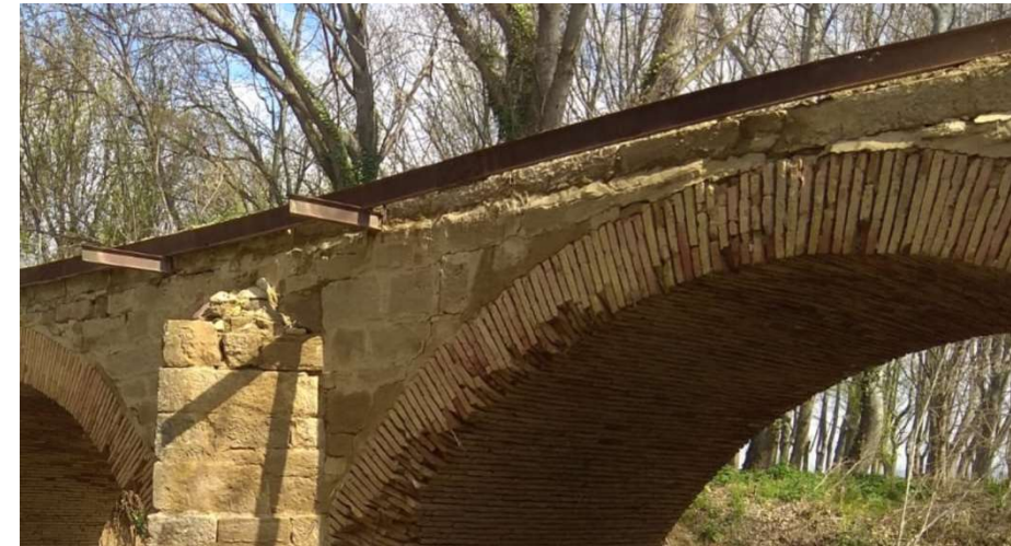
Figura 5 - Pérdida de material de junta en piezas de sillería de los tímpanos y tajamar
