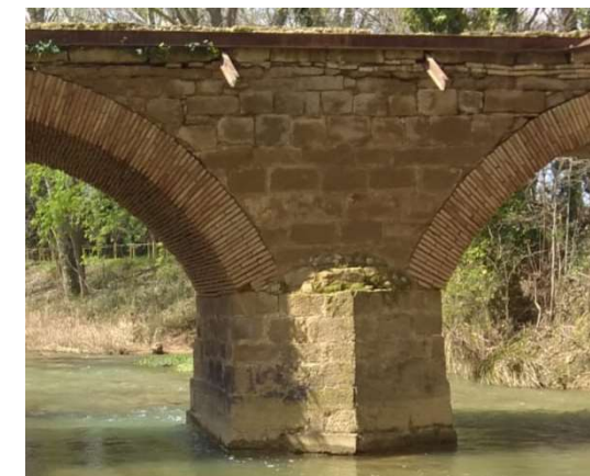
Figura 7 - Desaparición de las piezas que formaban la coronación del tajamar
