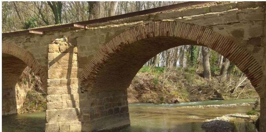
Figura 3 - Bóvedas de fábrica con pérdida de piezas y piezas dañadas. Vista desde la margen del río.
