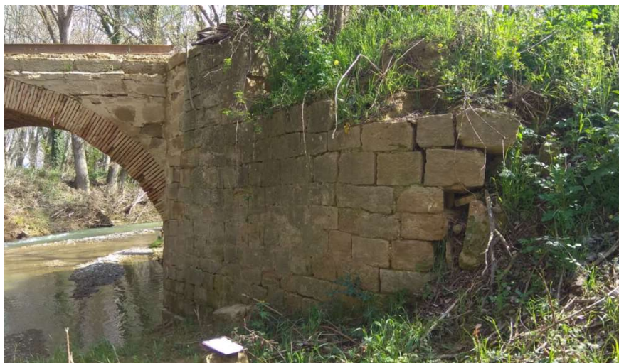
Figura 4 - Pérdida de material de junta y movimiento de piezas en el estribo derecho
