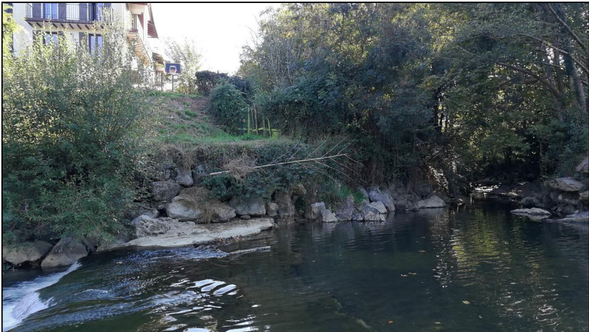
Desembocadura de la regata Zia con protección inestable y deteriorada.
