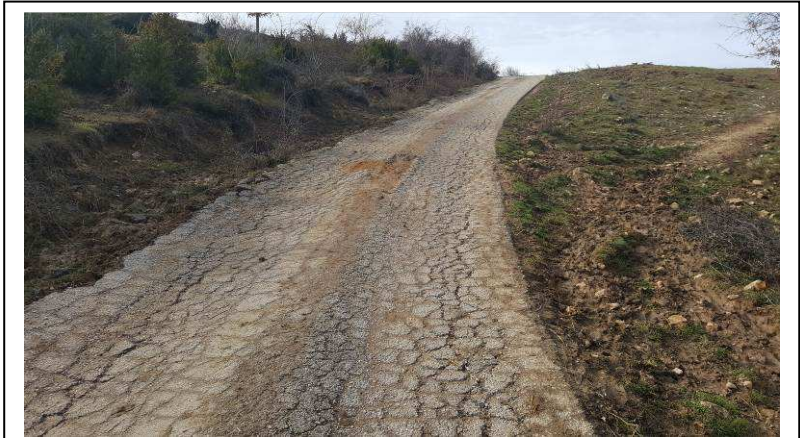
Tramo Muniain, con asfalto con defectos tipo “piel cocodrilo”
