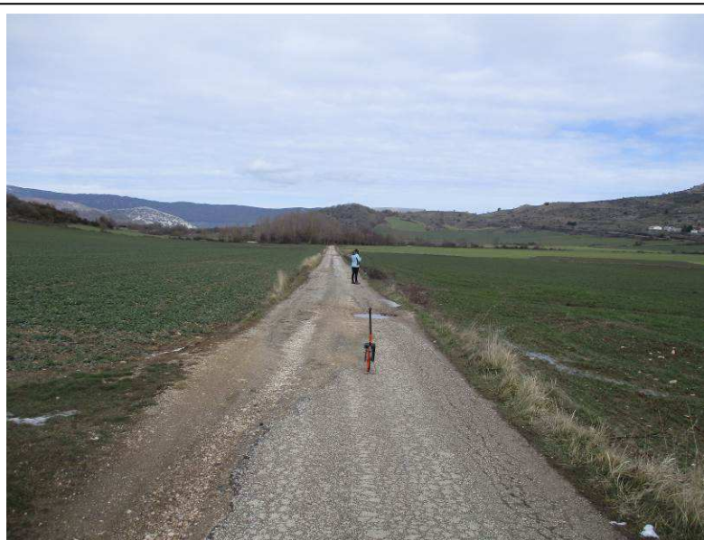
Tramo 32 a rehacer en base y anchura
