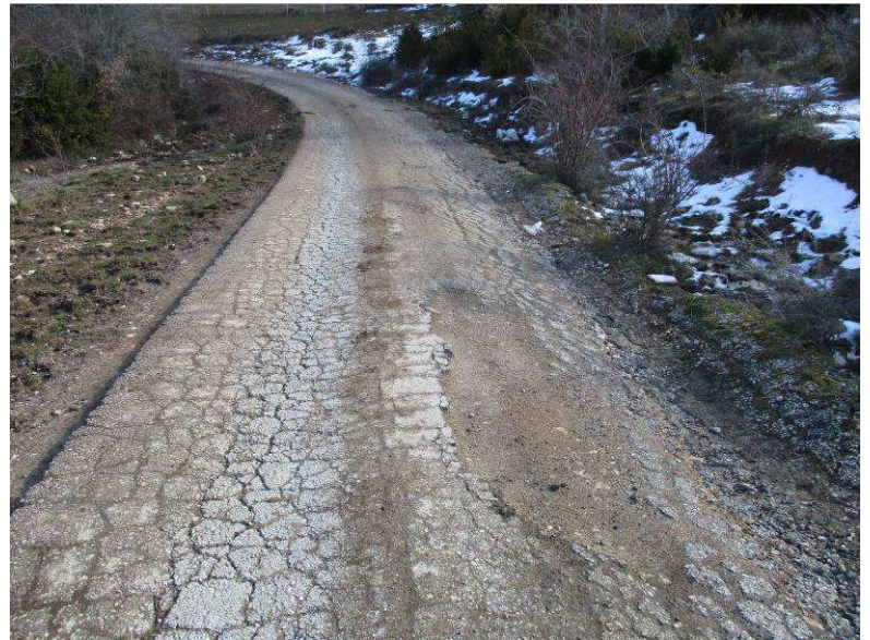
Tramo 7 con deformaciones en la capa base
