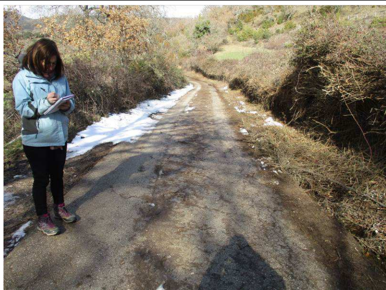
Tramo 9 con cuneta anegada por áridos
