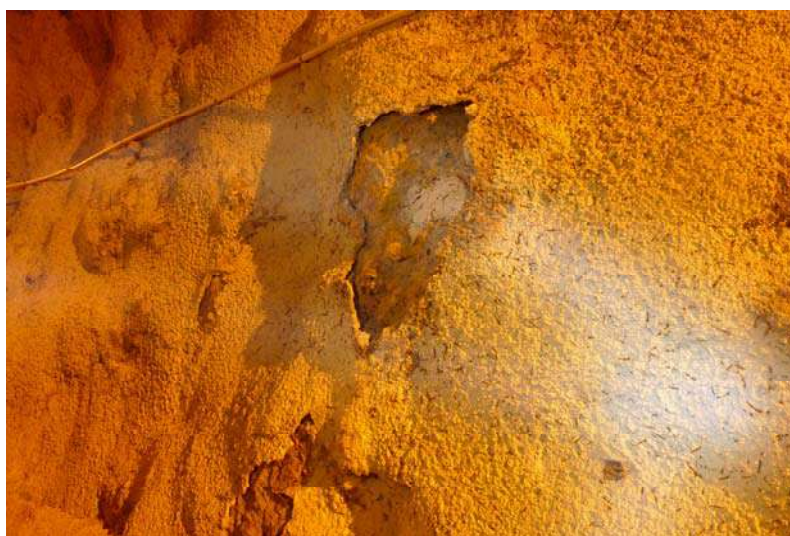
Detalle de poco espesor de hormigón proyectado en ST7
