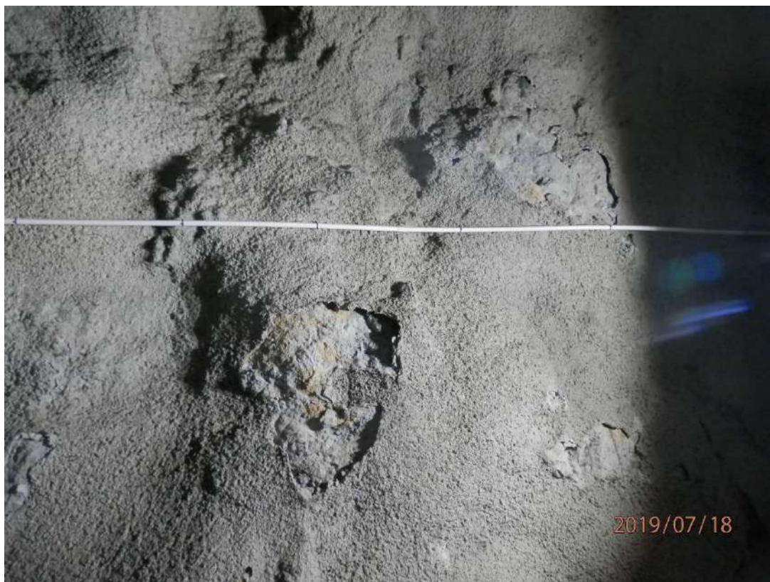
Fotografía 1. En la imagen se pueden observar desconchones en la gunita.
