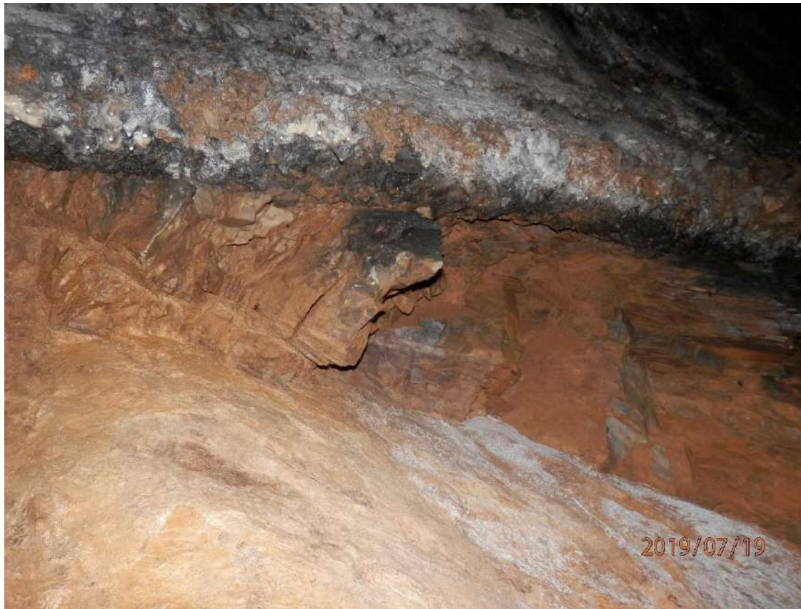
Fotografía 2. La roca se encuentra meteorizada y se ha perdido el apoyo de la bóveda
