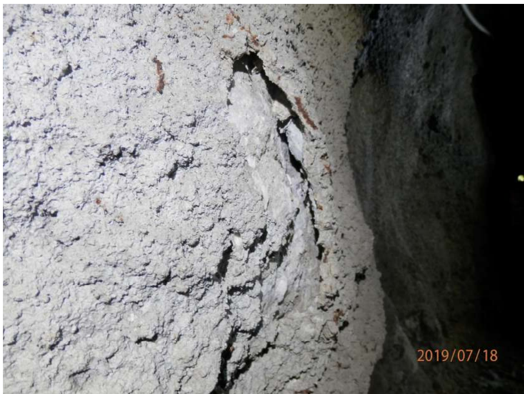
Imagen 2. Hormigón proyectado con abombamientos y desconchones en el túnel de Leitza.
