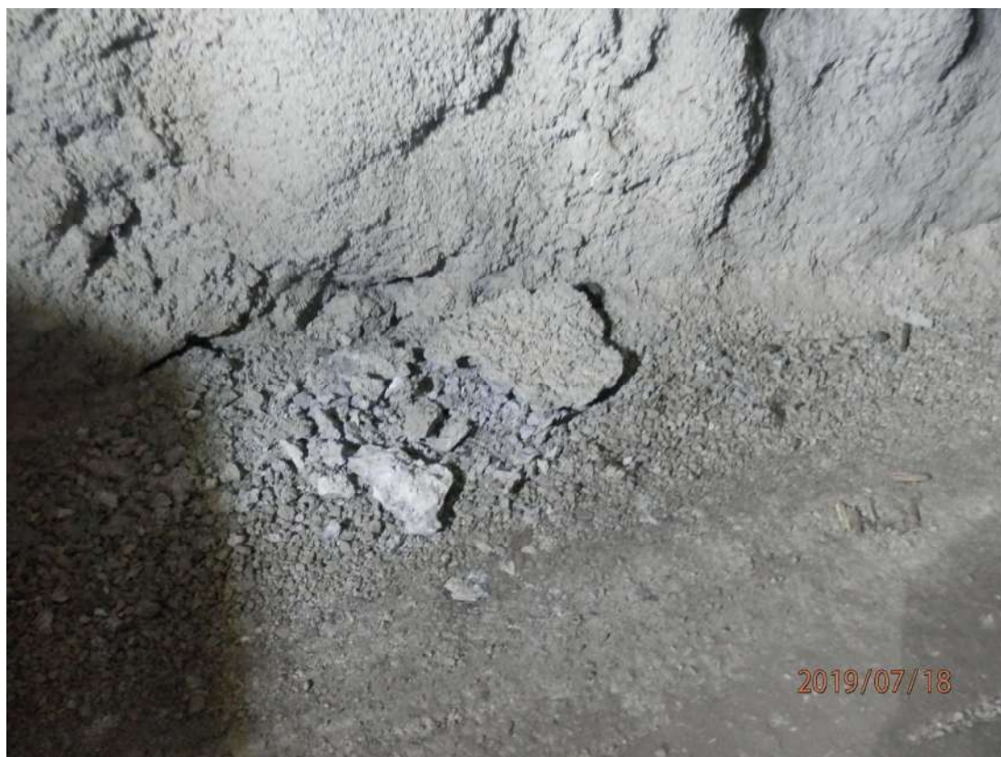
Imagen 3. Caídas de bloques de gunita.
