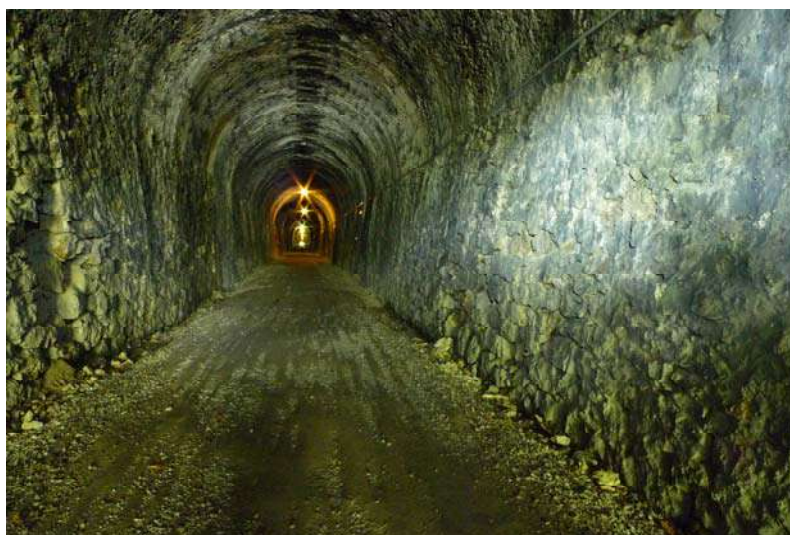
Muros de mampostería deformados en ST1
