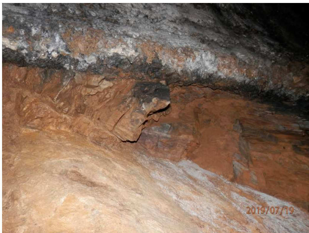
Imagen 4. Descalce de bóvedas en Túnel de Leitza
