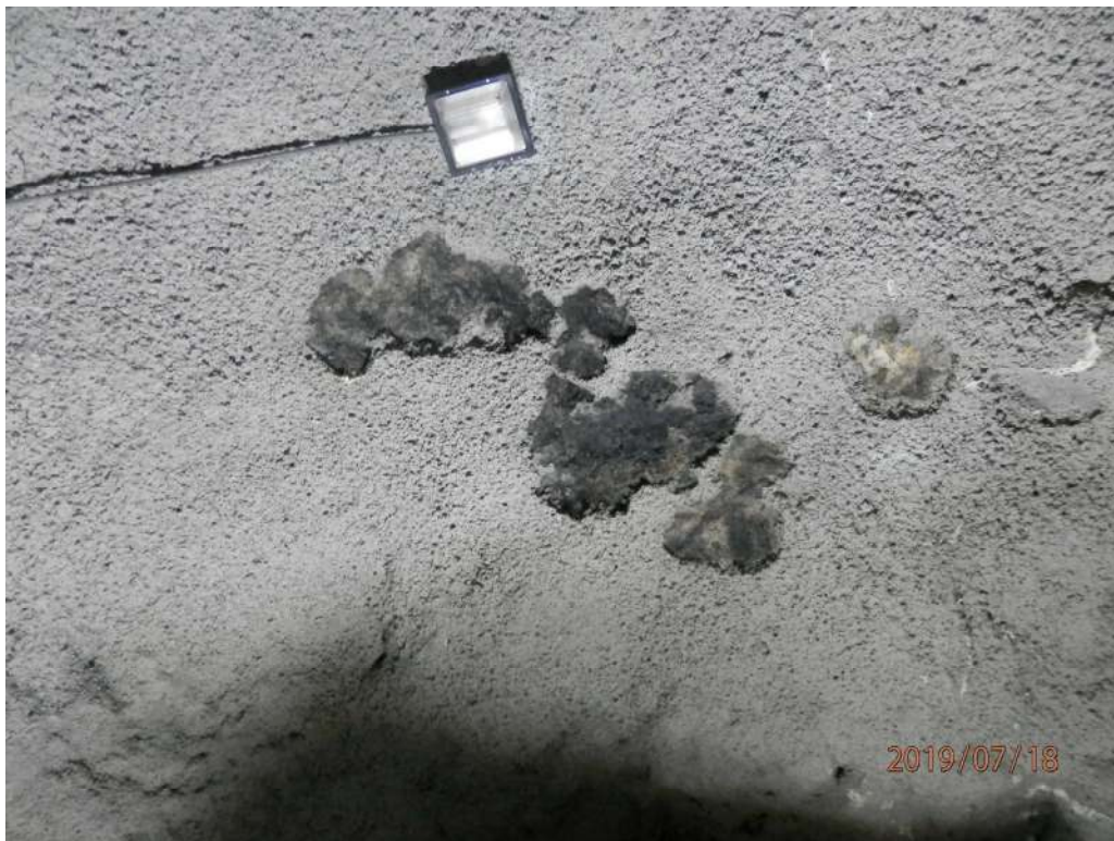
Imagen 1. Desconchones en la clave en un tramo de hormigón proyectado del túnel de Leitza.
