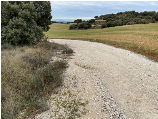
Ilustración 18. Detalle del tramo 4 de la Pista 3 en el que se han formado surcos por la circulación del agua de escorrentía.
