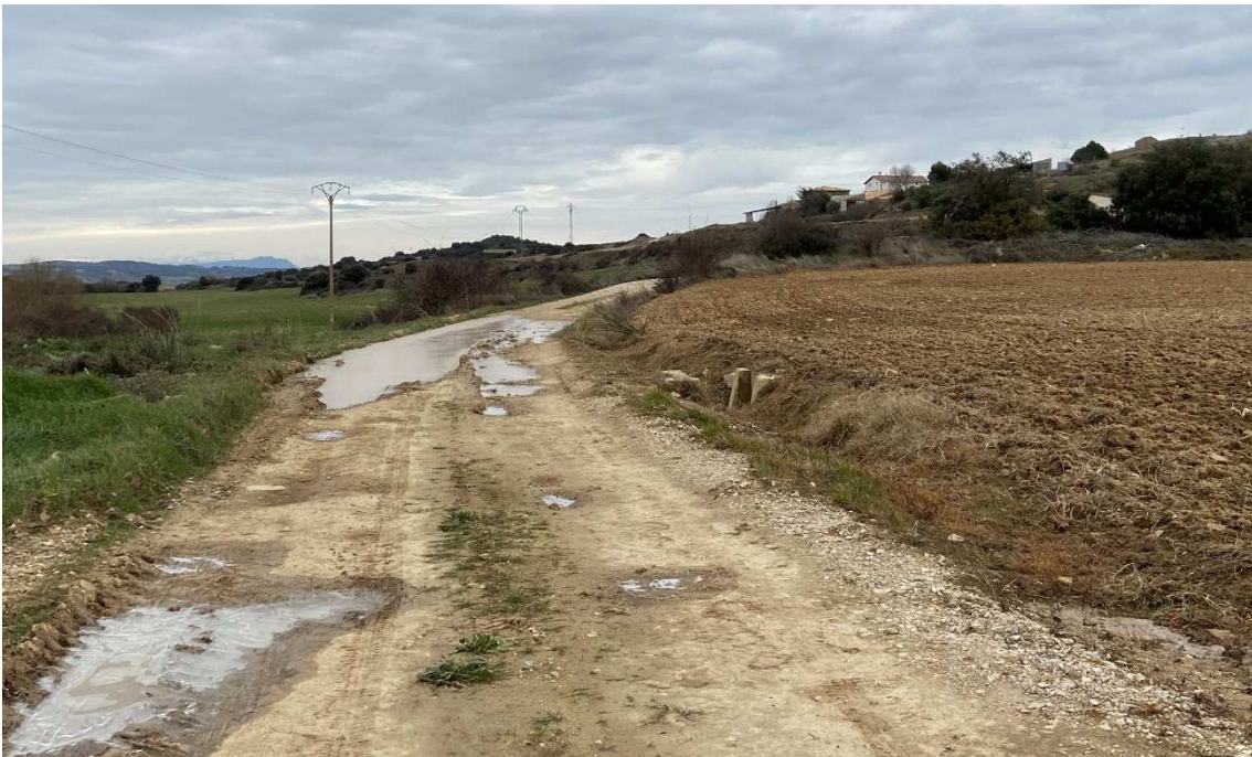
Ilustración 37. Tramo 7 de la Pista 6 en el que prácticamente no queda material granular y la irregularidad de la superficie hace que se produzcan encharcamientos sobre tierra.
