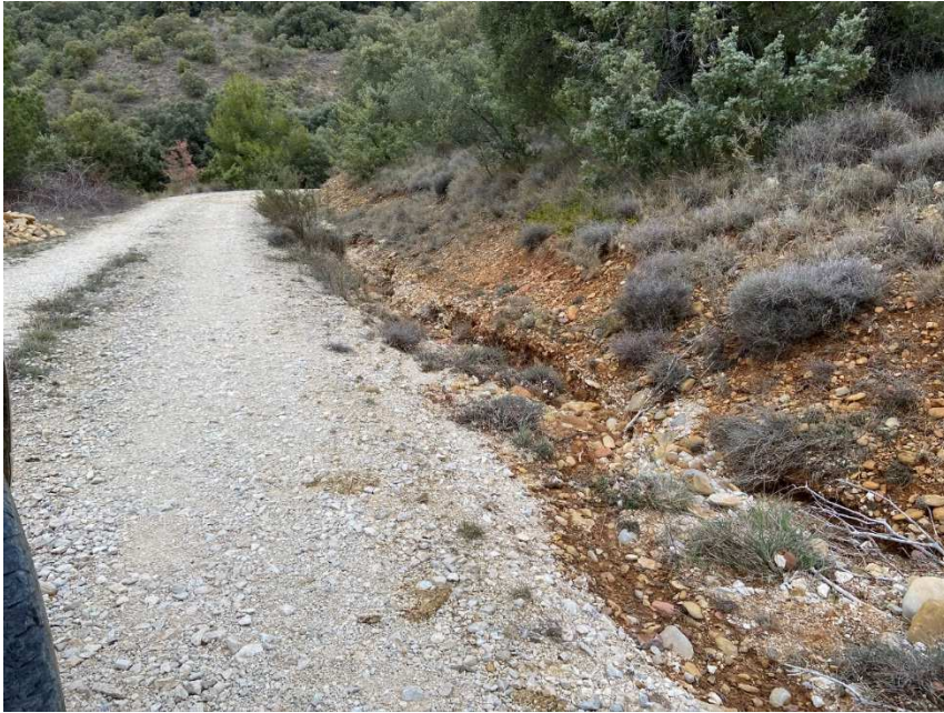
Ilustración 20. Detalle del tramo 6 de la Pista 3 en el que se aprecia un tramo de cuneta colmatada por el material arrastrado.
