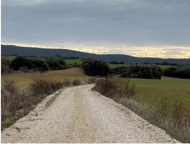
Ilustración 39. Detalle del tramo 1 de la Pista 7 en la que se puede ver que el material ha sido arrastrado y actualmente se encuentra acumulado en los extremos de la explanación.
