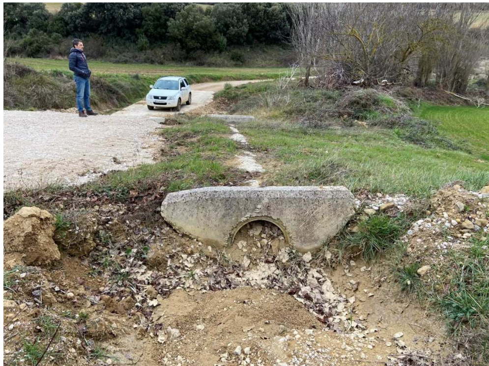
Ilustración 43. Paso salvacunetas totalmente colmatado (Actuación puntual 9).
