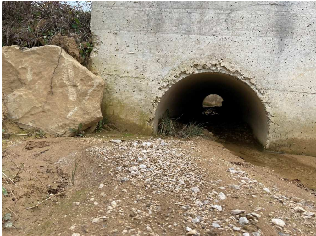
Ilustración 45. Detalle de caño parcialmente colmatado (Actuación puntual 10)
