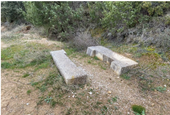
Ilustración 34. Detalle de la embocadura de caño totalmente colmatado.
