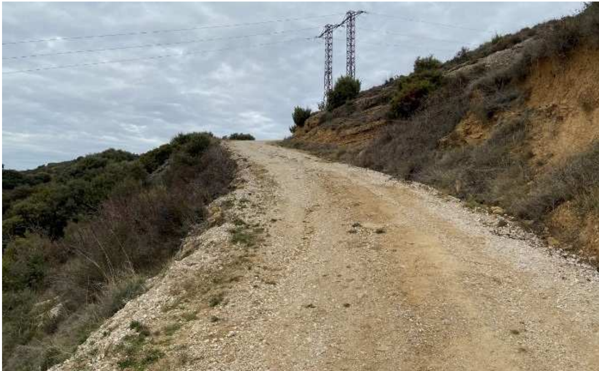
Ilustración 27. Situación en la que se encuentra el tramo 1 de la Pista 5. Como consecuencia de las lluvias torrenciales se han formado regueros en la explanación y se ha lavado el material que ha terminado depositándose en la cuneta y en el talud del terraplén.
