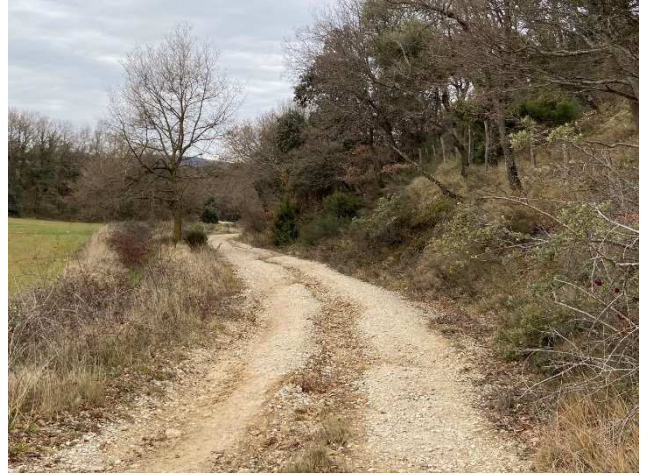
Ilustración 25. Situación actual del tramo 2 de la pista 4. Se observan los surcos formados en la explanación y la colmatación de las cunetas por el arrastre de materiales.
