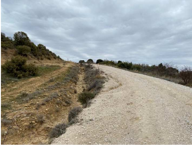
Ilustración 24. Estado del tramo 1 de la Pista 4 en el que el agua ha formado surcos y se ha arrastrado el material.
