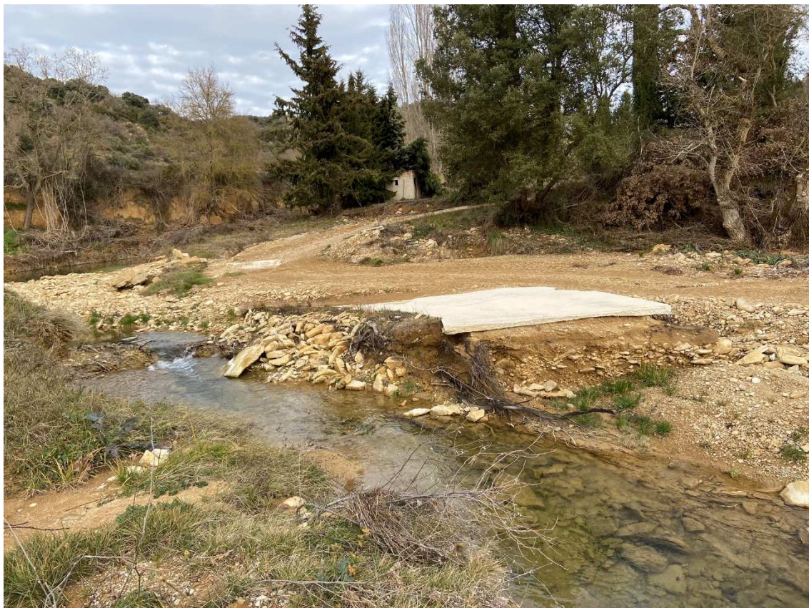
Ilustración 47. Tramo 1 de la Pista 8 en el que se ve el resto de pavimento de hormigón que ha quedado desplazado. (Foto tomada desde la margen derecha del río).
