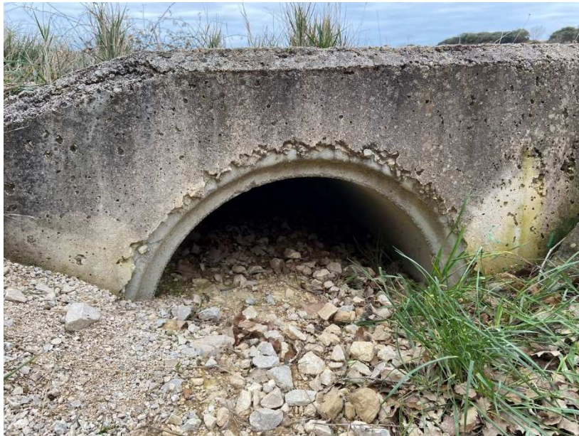
Ilustración 28. Detalle de paso salvacunetas totalmente colmatado. (Actuación puntual AP6)
