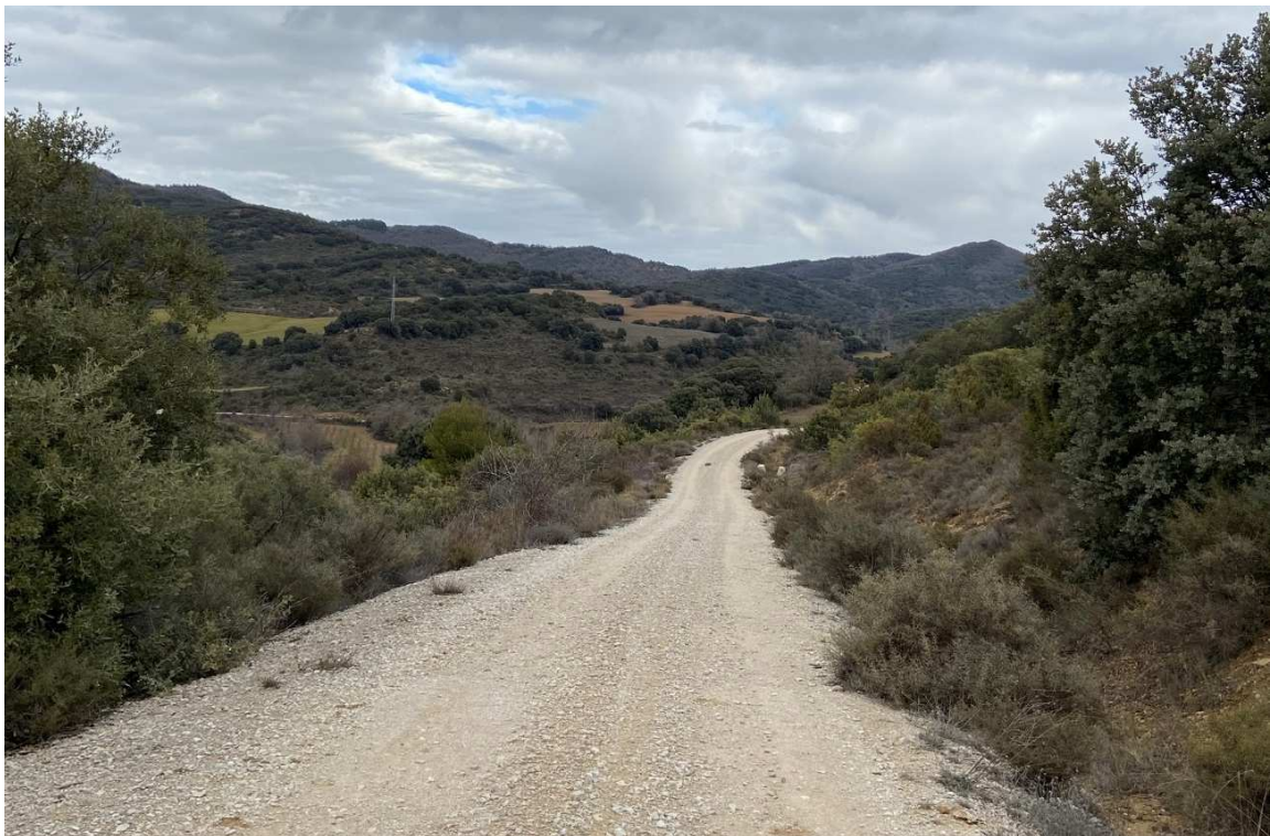
Ilustración 30. Ejemplo del estado en el que se encuentran los tramos 4 y 5 de la pista 5.
