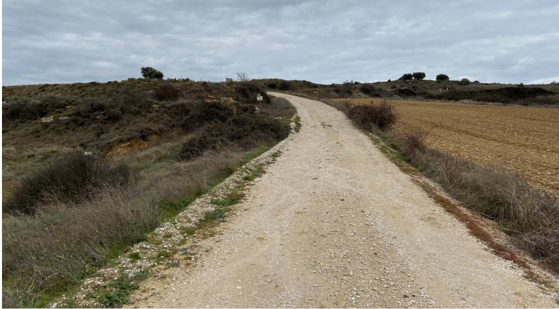
Ilustración 38. Tramo 8 de la Pista 6. Es necesario el repaso de la explanación, la limpieza de cunetas y aportar 10 cm de material.
