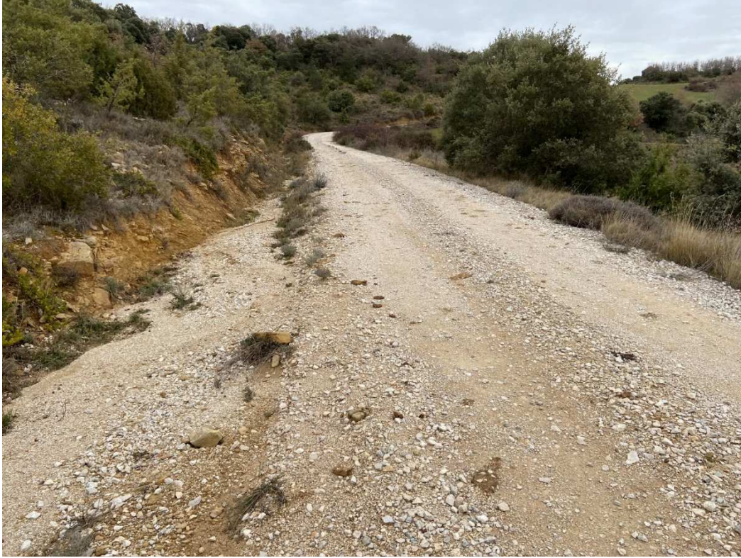
Ilustración 32. Tramo 6 de la Pista 5. Es evidente el arrastre y depósito en la cuneta del material granular que conformaba el afirmado de la pista.
