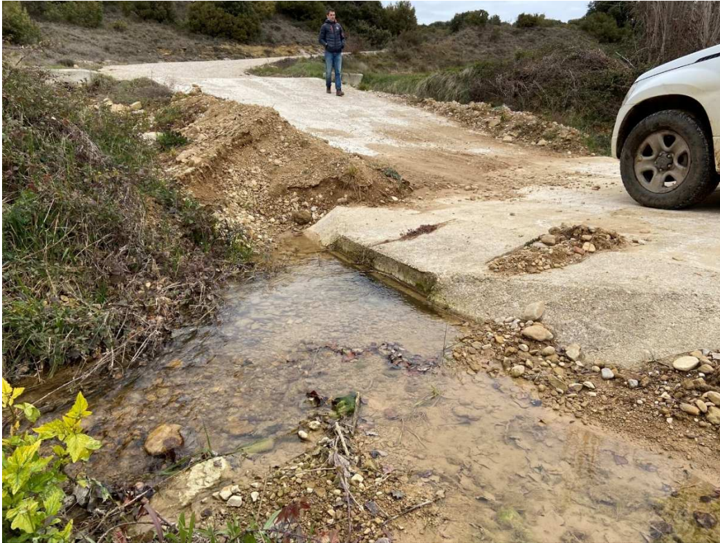
Ilustración 42. Caño bajo pavimento de hormigón totalmente colmatado (Actuación puntual 8).
