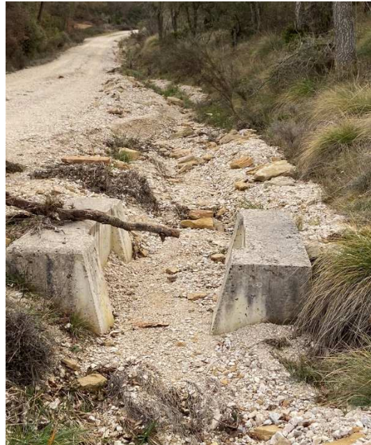
Ilustración 6. Detalle de la entrada de caño totalmente aterrado. (Actuación Puntual 2).
