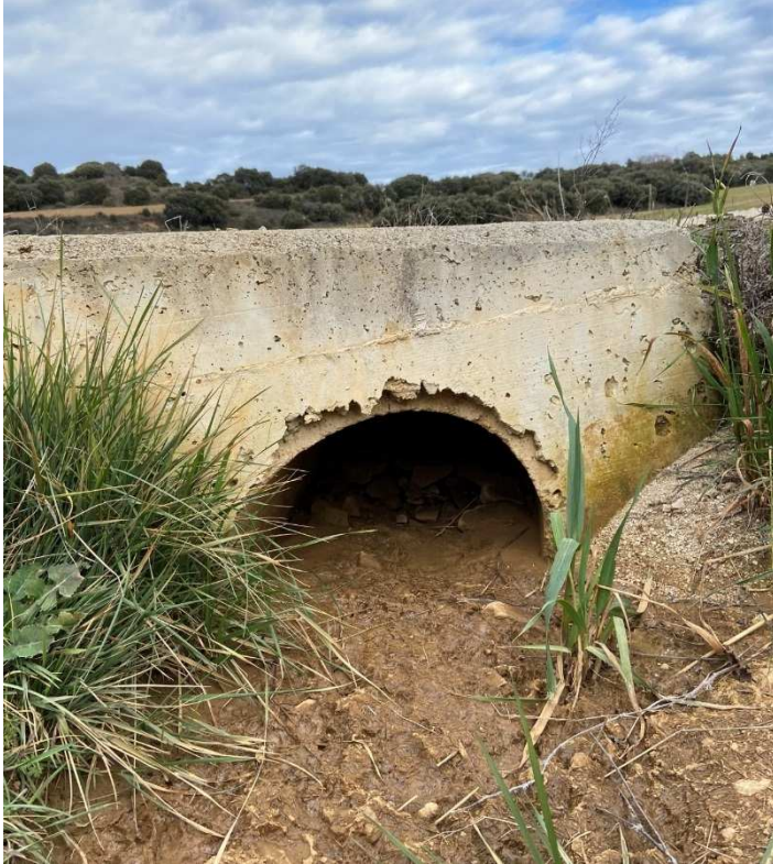
Ilustración 17. Situación actual de caño parcialmente colmatado. (Actuación Puntual 5)
