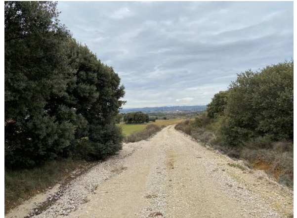
Ilustración 40. Estado actual del tramo 3 de la Pista 7, en el que es evidente el arrastre de material y su depósito en la cuneta.
