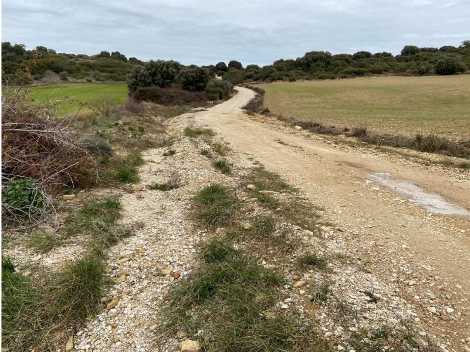
Ilustración 44. Tramo 5 de la Pista 7. El material ha sido arrastrado por el agua fuera de la plataforma y se ha depositado en la cuneta.
