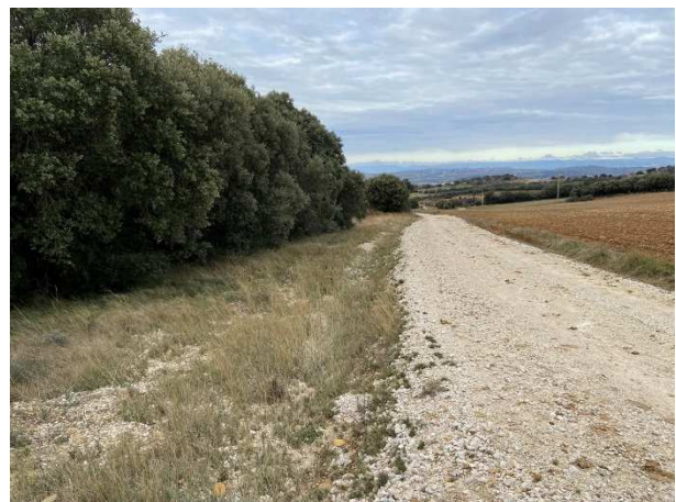
Ilustración 19. Detalle del tramo 5 de la Pista 3 donde se puede ver el material depositado fuera de la vía.
