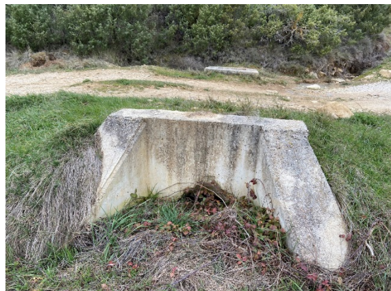
Ilustración 35. Detalle de la salida de caño transversal totalmente colmatado.
