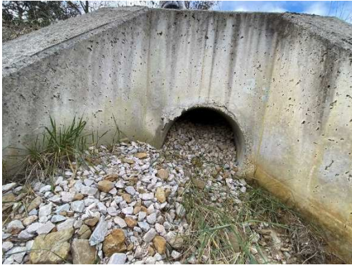
Ilustración 5. Detalle de la salida de caño totalmente aterrado (Actuación Puntual 2).
