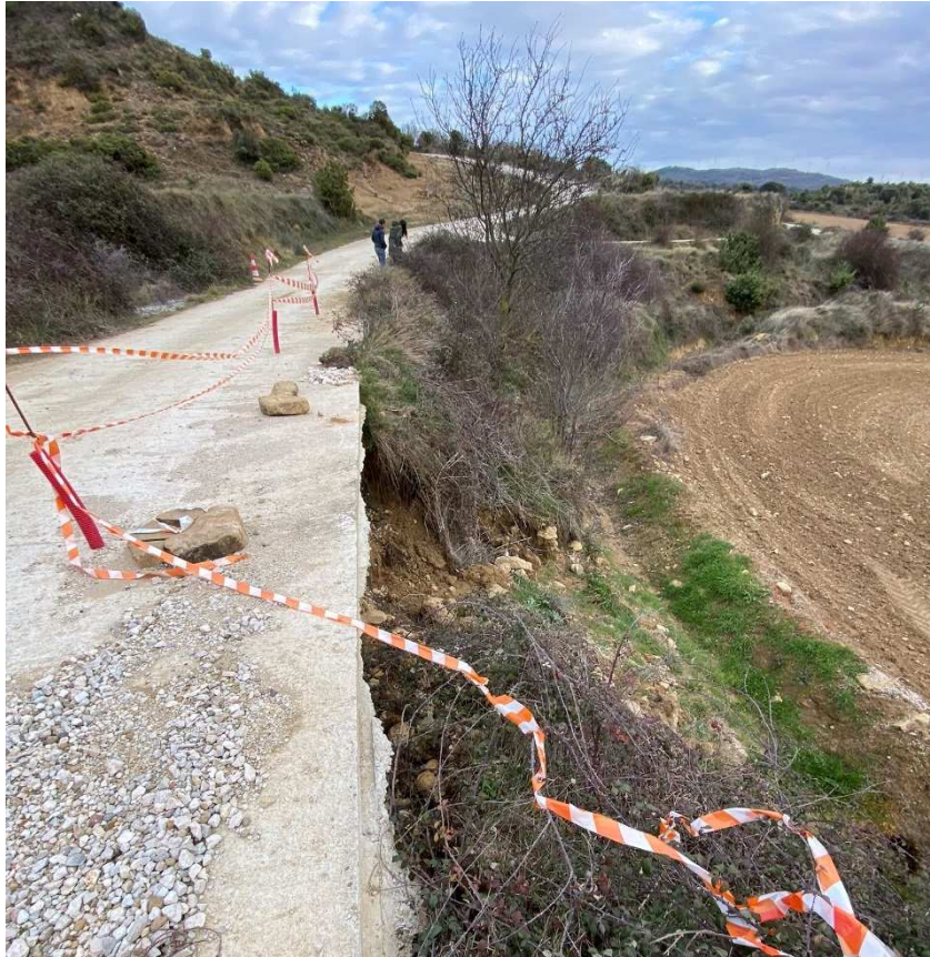
Ilustración 22. Tramo de pavimento de hormigón que ha quedado descalzado por el derrumbe del talud. Tramo 0 de la Pista 4.
