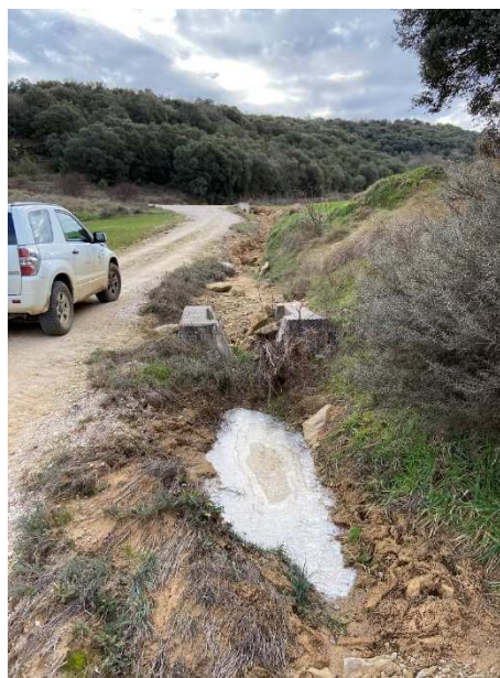
Ilustración 2. Detalle de caño totalmente aterrado (Pista 1, Actuación puntual 1).
