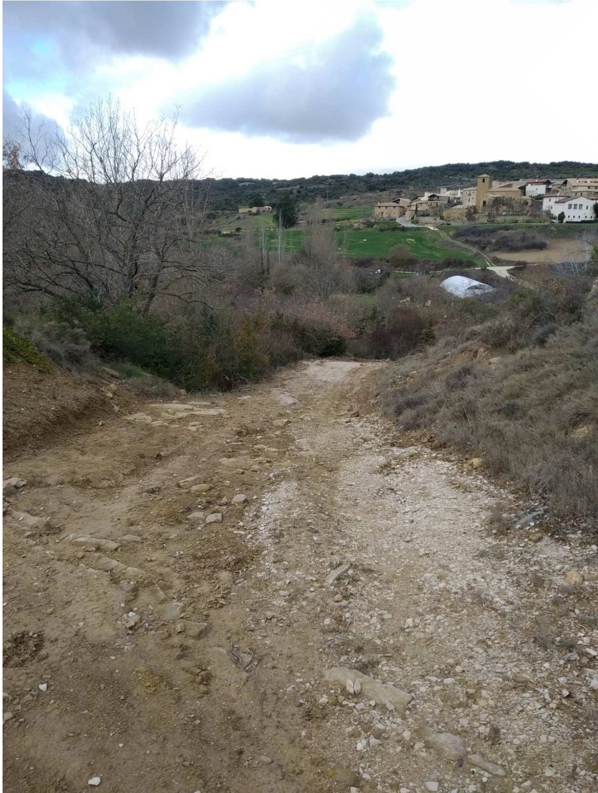
Ilustración 49. Tramo 1 de la Pista 9 en el que el agua ha arrastrado el material.
