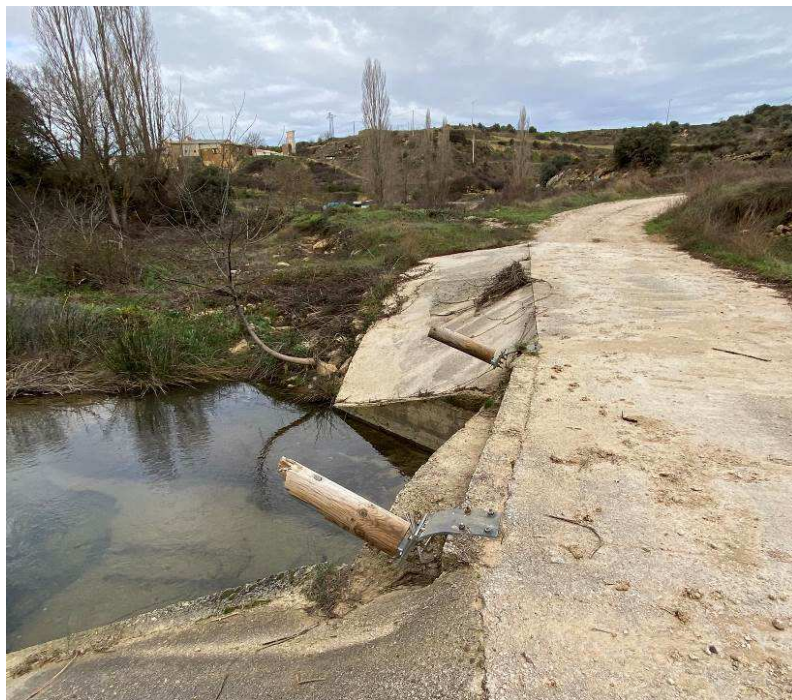
Ilustración 7. Barandilla dañada en paso sobre el río Sansoain.
