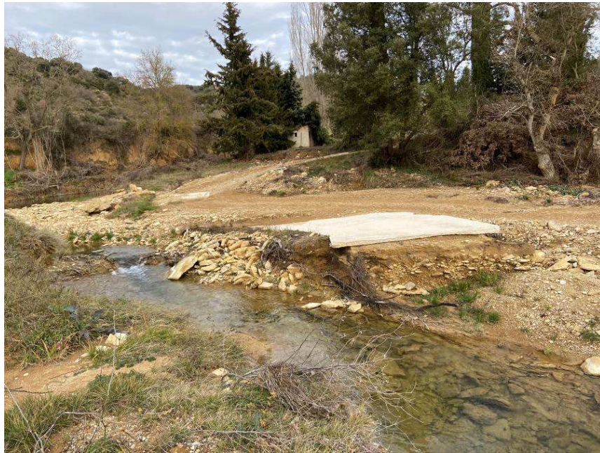
Ilustración 6. Punto en el que se encontraba un paso que ha sido arrastrado por el cauce.
