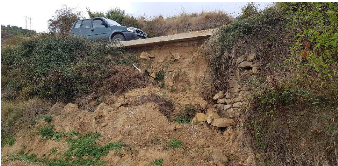
Ilustración 5. Tramo de pavimento de hormigón que ha quedado en el aire.
