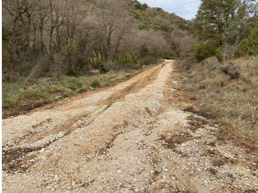
Ilustración 2. Daños provocados en pista con material granular, donde se pueden ver los regueros formados en la explanación, zonas que han quedado desprovistas de material y acumulación de éste en la cuneta.
