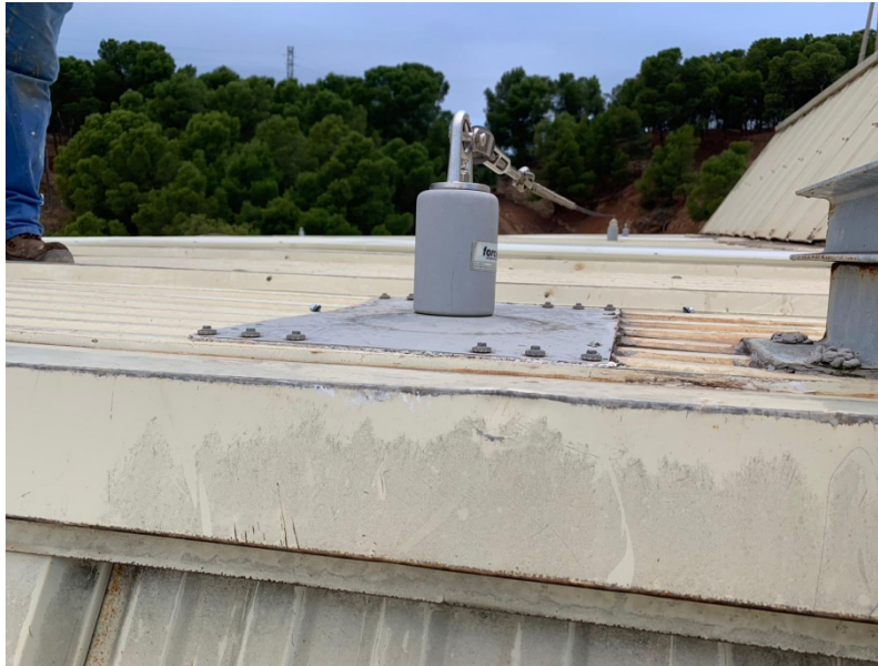
Fotografía de la línea de vida actual instalada, fuera de normativa de homologación
