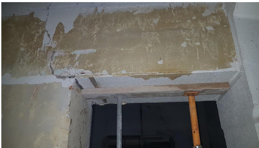
Planta primera (122f). Apeo de dintel sin garantía estructural
