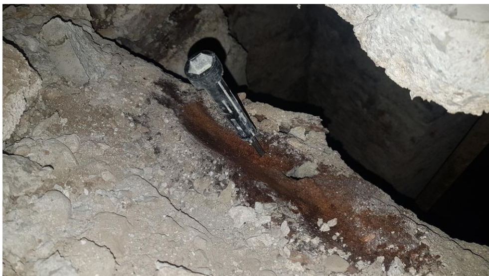
Planta baja (B11b). Pudrición en viguetas de madera (ver fotos anteriores)
