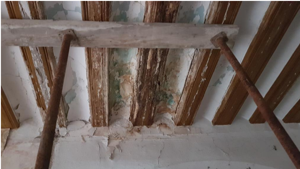
Entrepunta (E06). Apeo de estructura de madera con pudrición.
