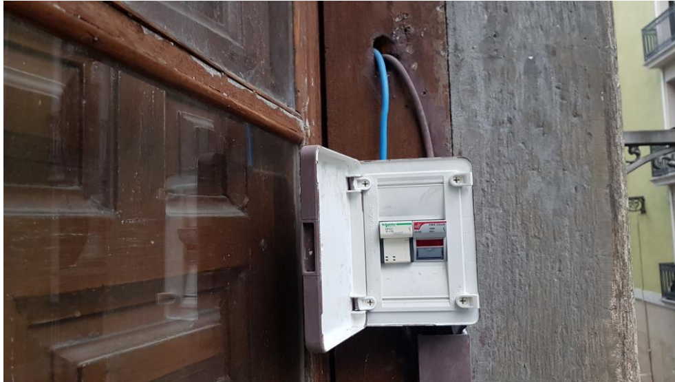
Planta primera (124a). Fusibles exteriores. Acometida ilegal
