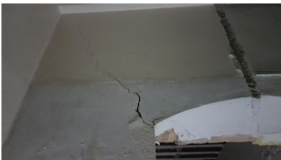
Planta primera (120c). Fisuración en dintel de hueco interior de fábrica
