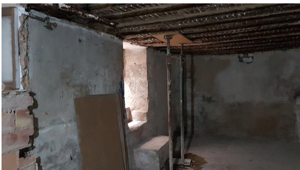
Planta baja (B01a). Apeo de estructura de madera con pudrición (ver foto B03)
