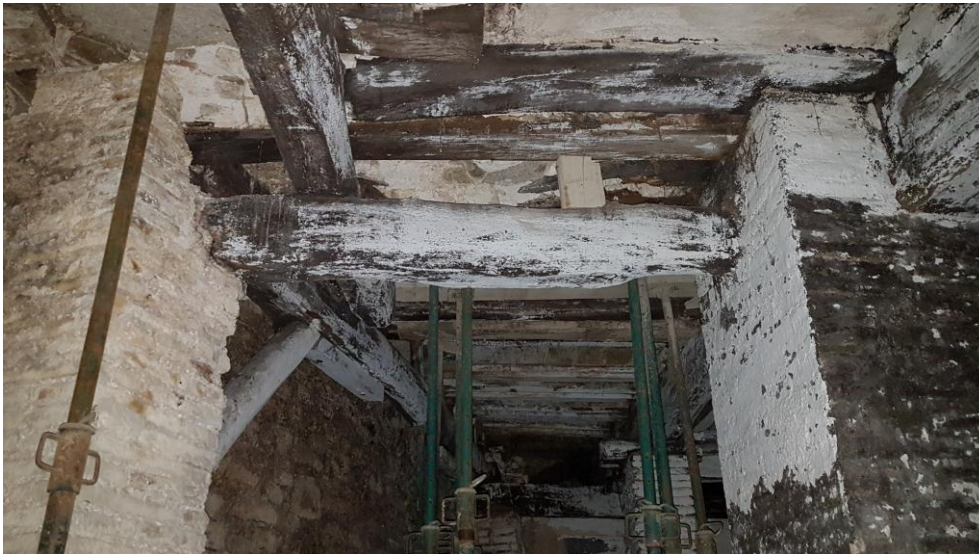
Planta sótano (S05). Apeo de estructura de madera con pudrición (ver foto B11b)
