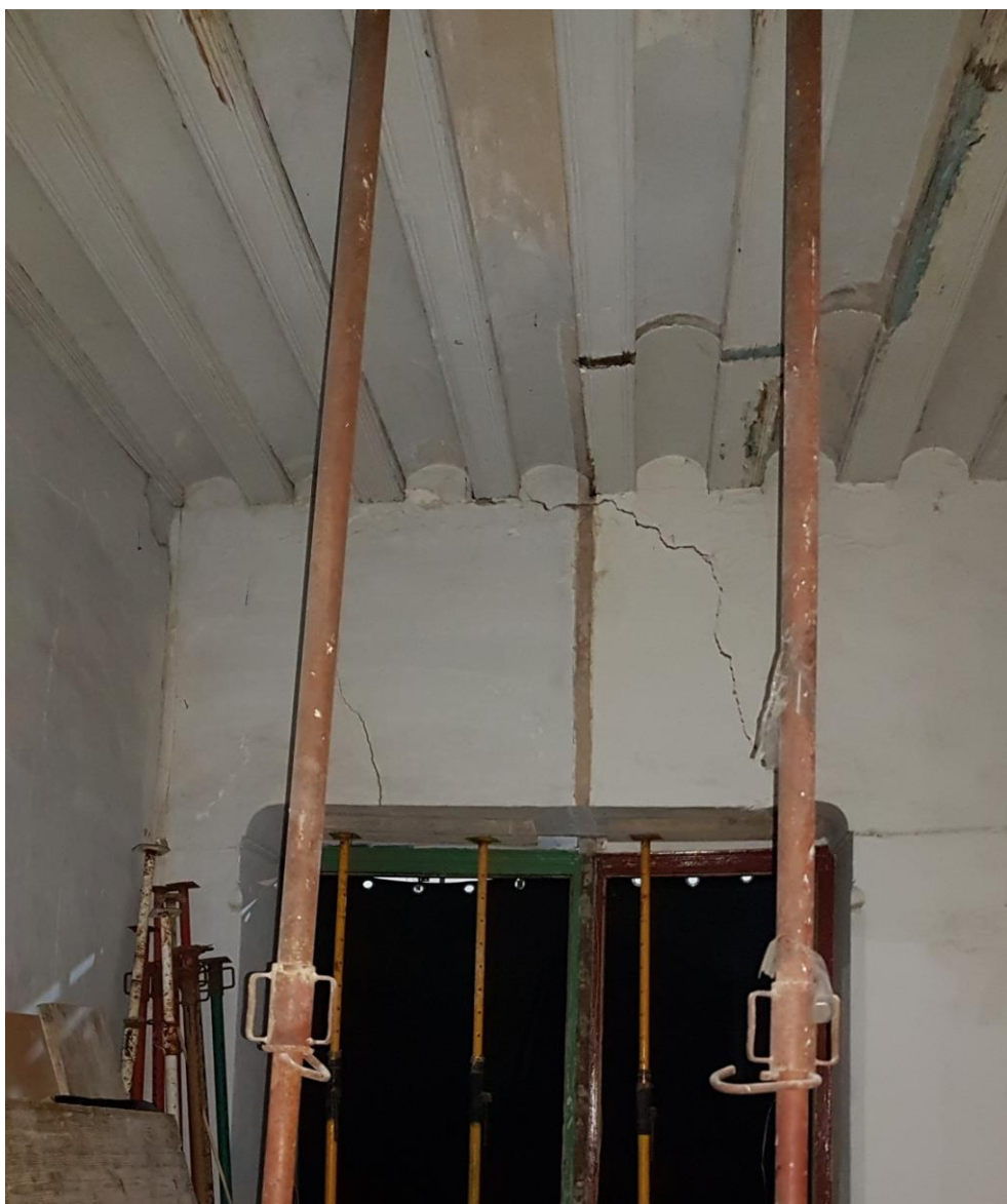
Planta segunda (203b). Apeo de estructura y hueco interior. Fisuración de la fábrica
