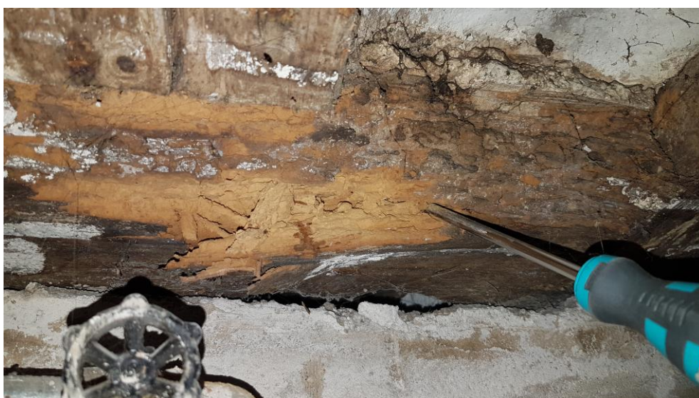
Planta baja (B02c). Viga durmiente de madera. Pudrición
