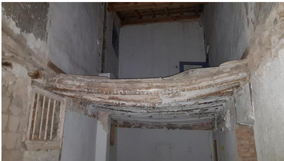
Planta primera (102a). Forjado en ruina con riesgo grave de caída
