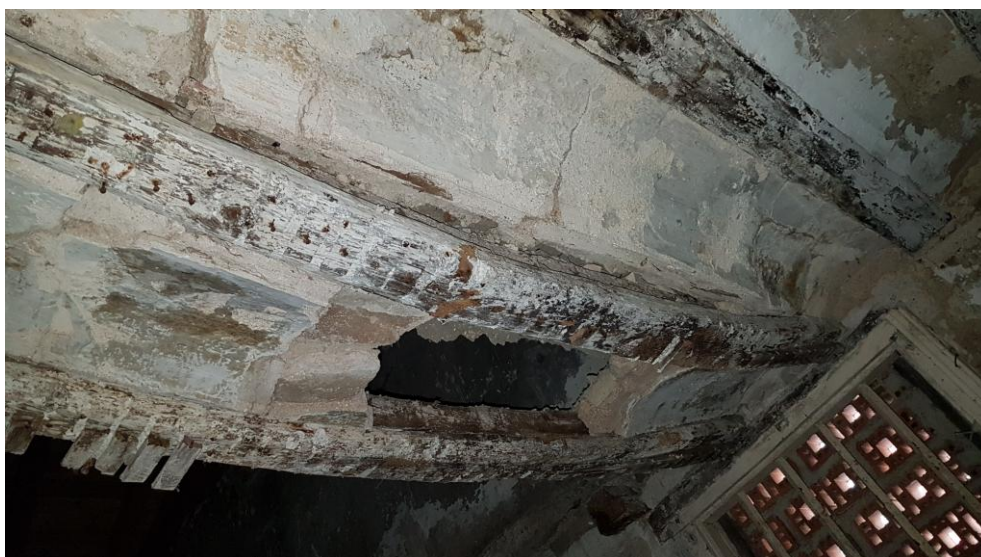
Planta primera (101c). Forjado en ruina con riesgo grave de caída
