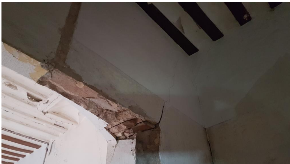
Planta primera (121a). Fisuración en dintel de hueco interior de fábrica
