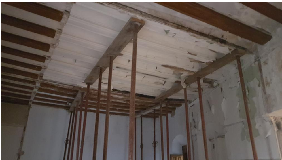
Entrepunta (E03d). Apeo de estructura de madera con pudrición. Forjado en ruina
