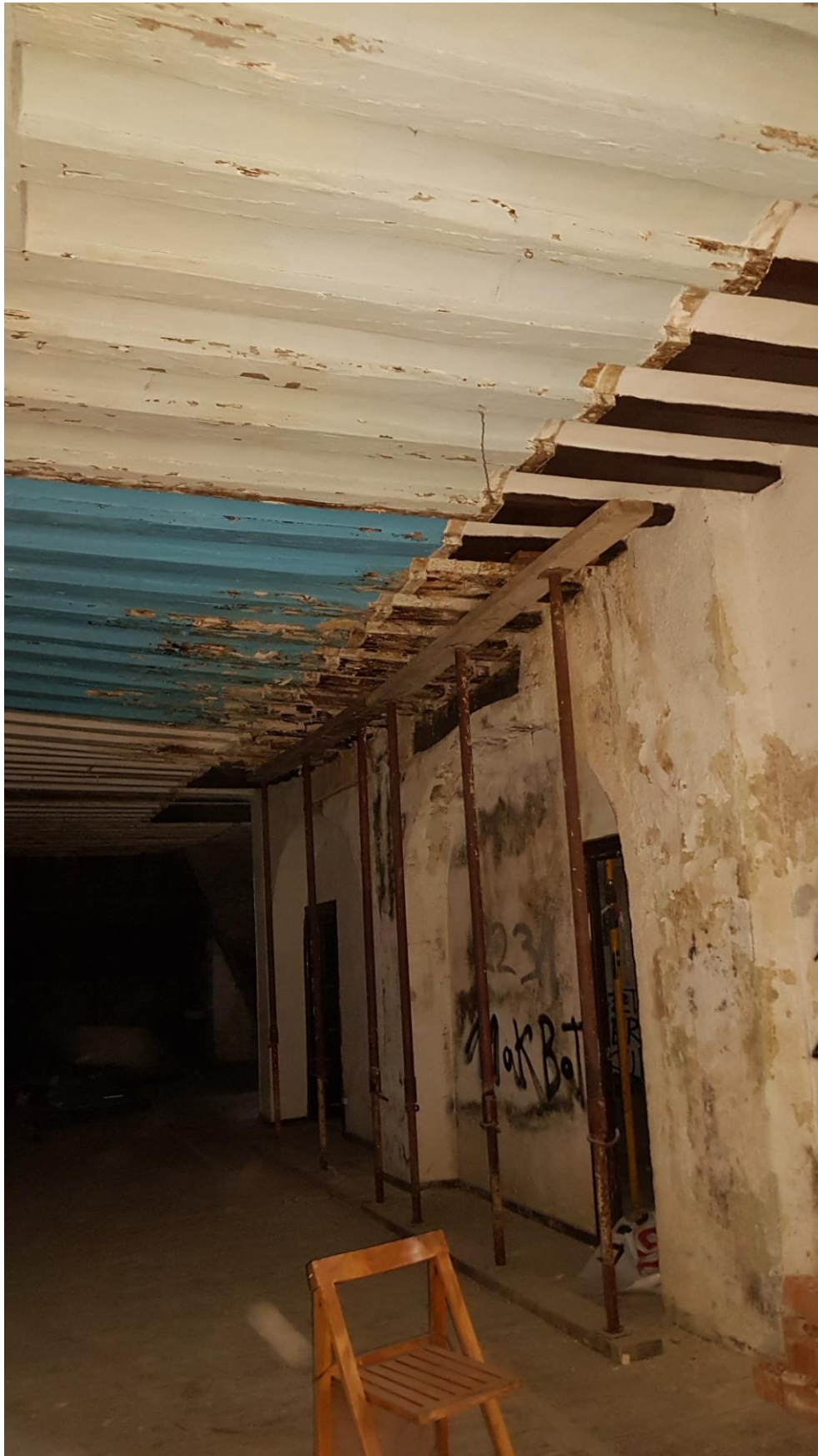
Planta tercera (303). Apeo de estructura de madera con pudrición. Forjado en ruina
