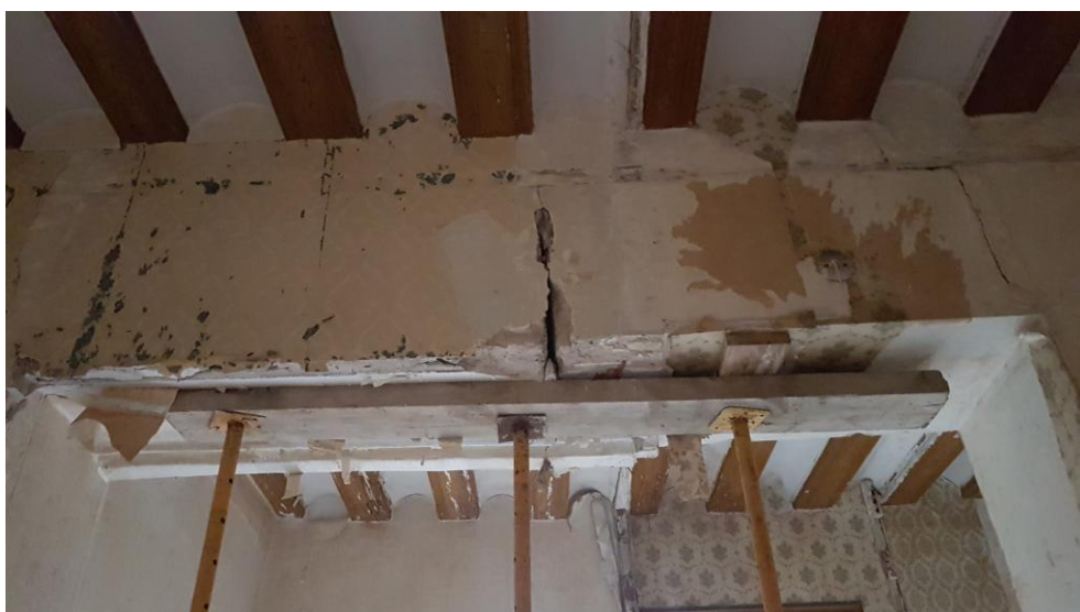
Entreplanta (E02c). Apoyo y acuña dintel de un hueco de paso.
