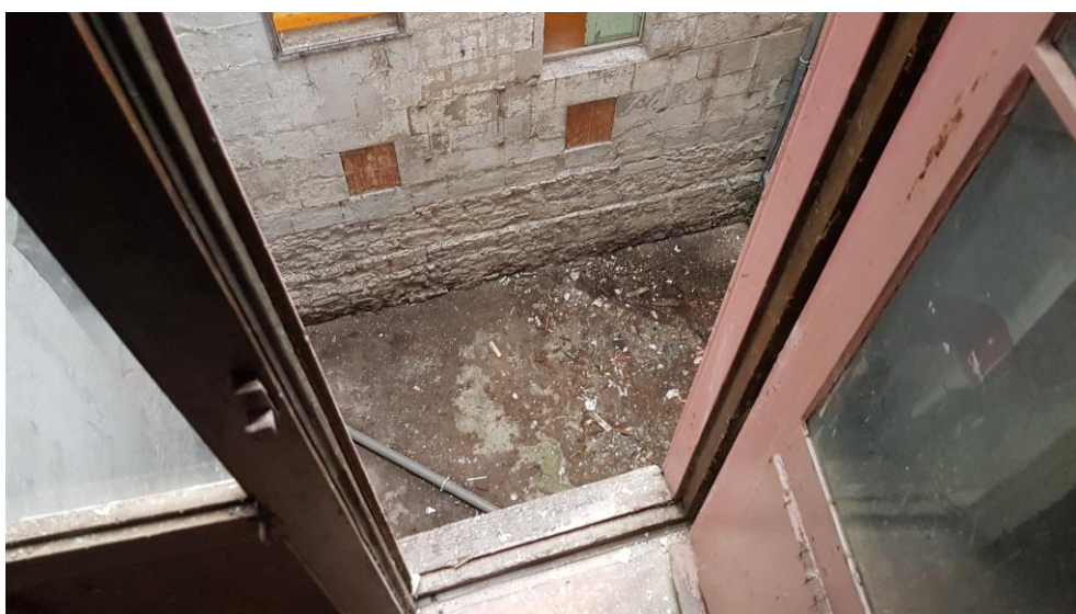
Planta primera (112d). Huecos sin protección para evitar caídas
