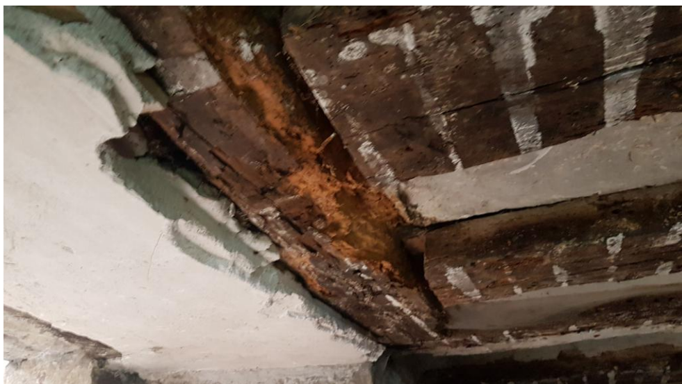
Planta baja (B03). Viga durmiente de madera. Pudrición
