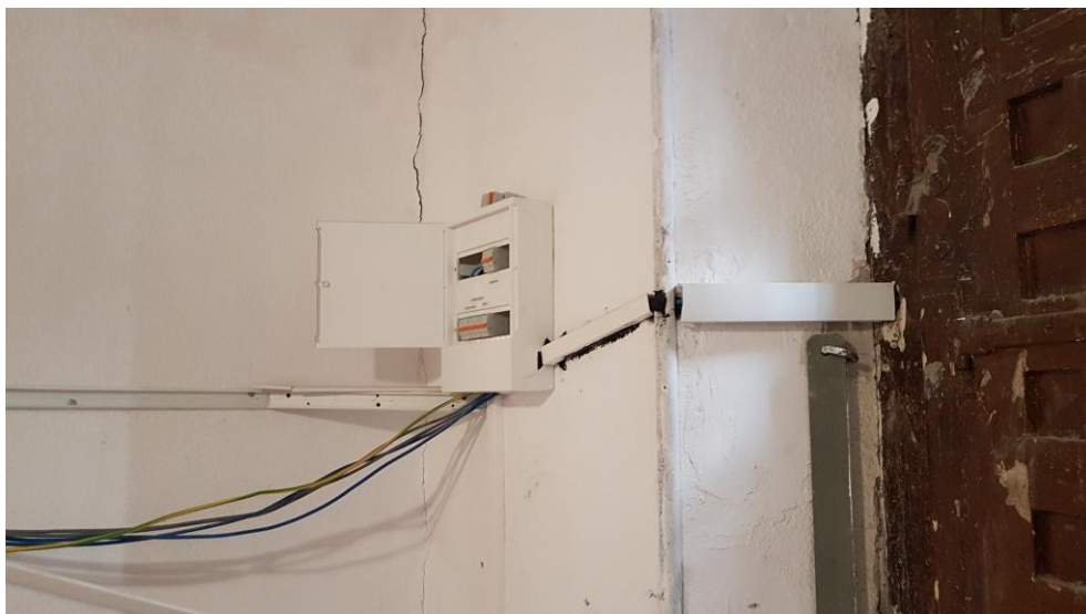
Planta primera (109a). Entrada al edificio. Cuadro y cableado en situación irregular
