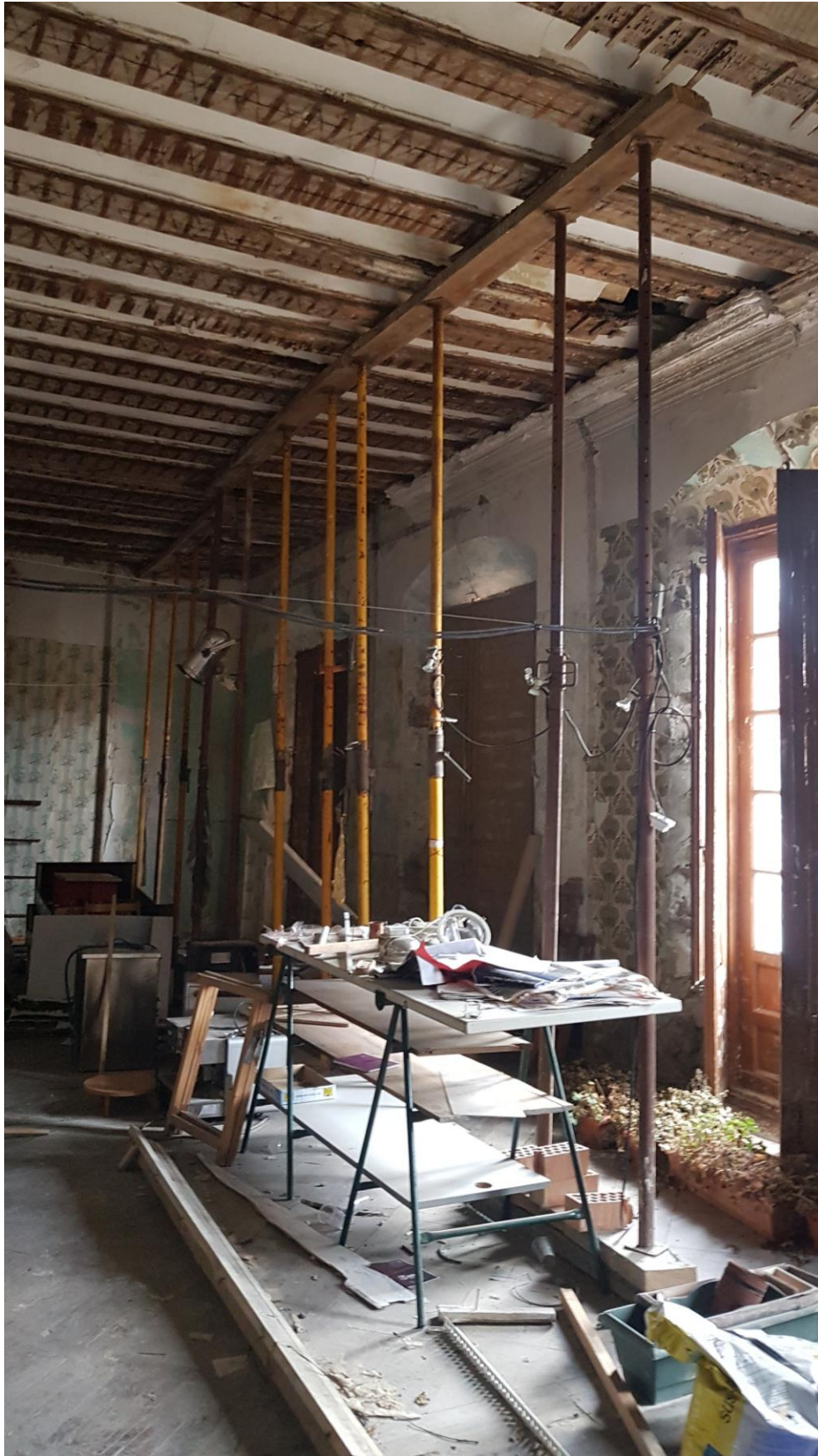
Planta primera (114a). Almacenaje y trabajo en zona con forjado en ruina
