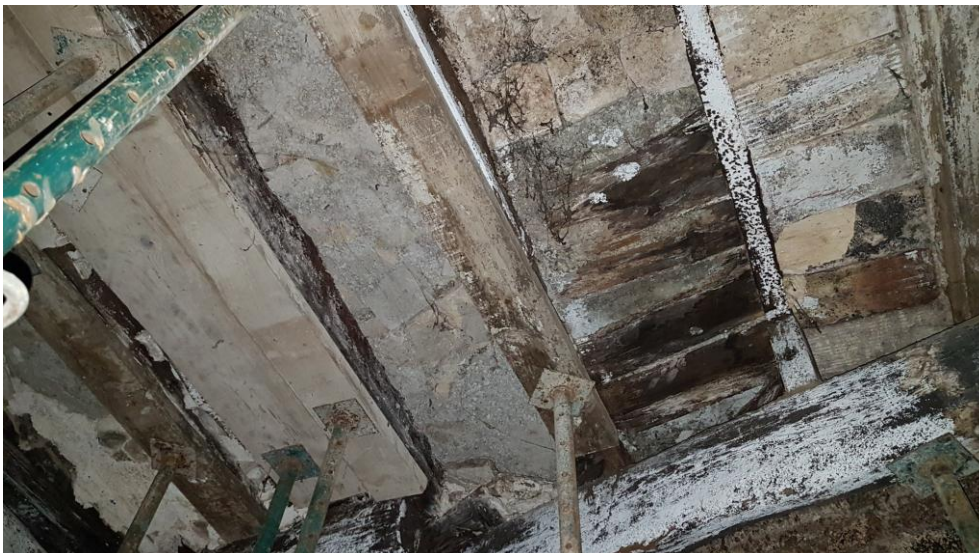
Planta sótano (S06). Apeo de estructura de madera con pudrición (ver foto B11b)
