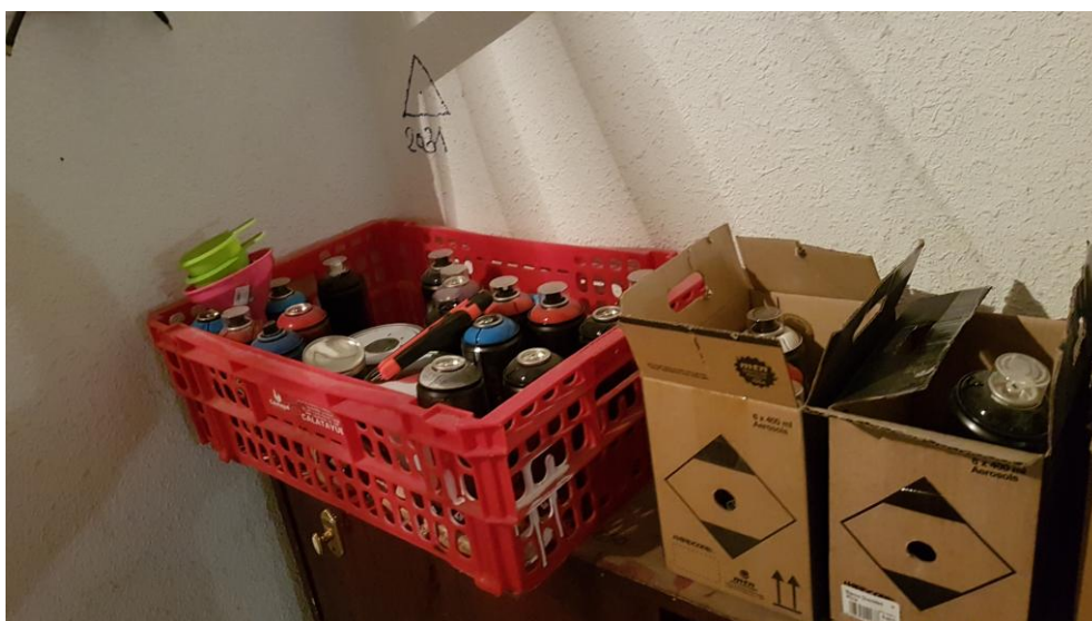
Planta primera (107). Acopio de pinturas junto a cuadro eléctrico sin protección adecuada
