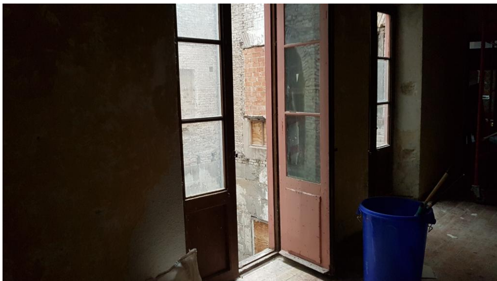
Planta primera (112c). Huecos sin protección para evitar caídas
