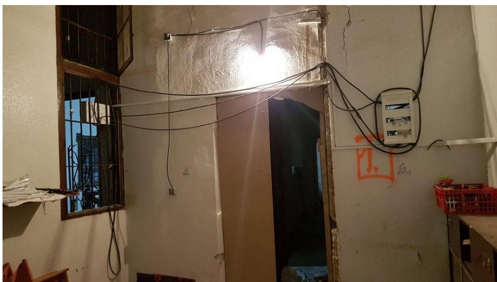
Planta primera (108b). Acopio de pinturas junto a cuadro eléctrico sin protección adecuada
