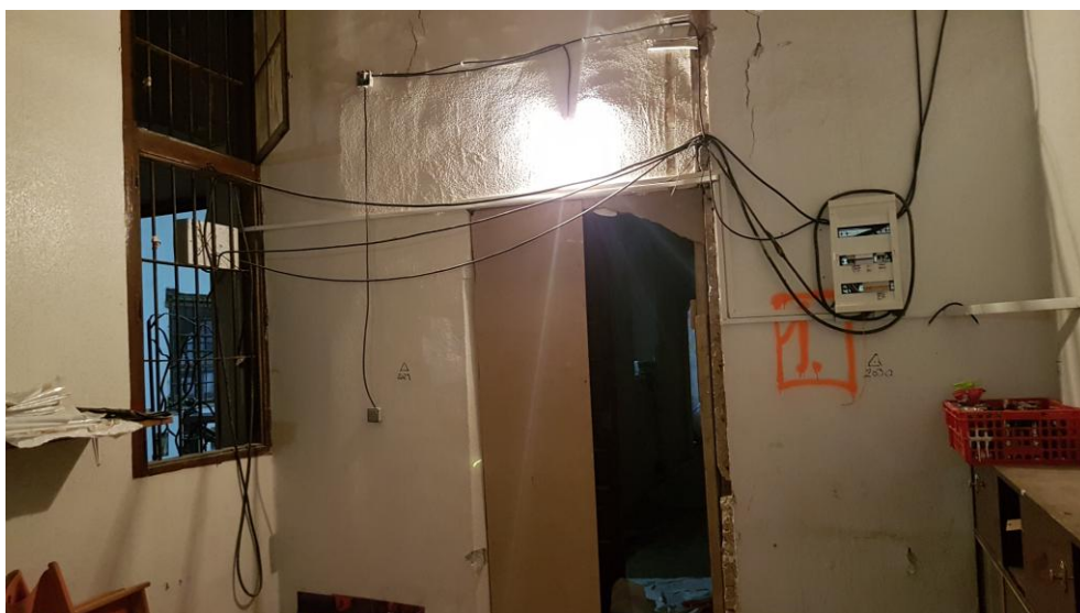
Planta primera (108b). Cableado accesible.
