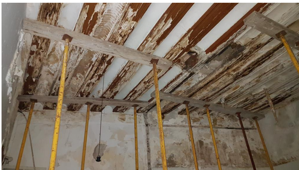
Planta primera (102a). Apeo de estructura de madera con pudrición. Forjado en ruina
