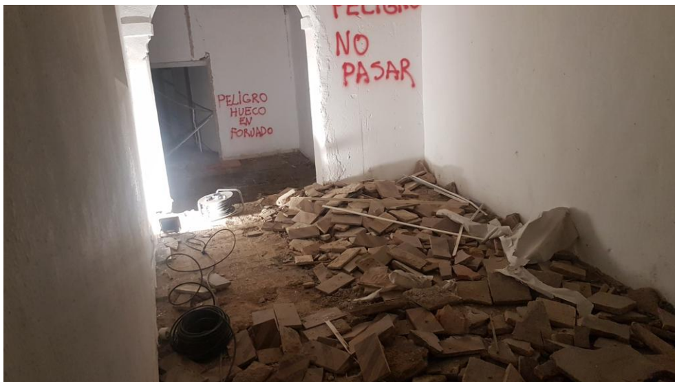
Entreplanta (E25a). Levante de pavimento y señalización de peligro
