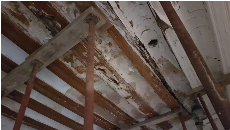
Entrepunta (E08a). Apeo de estructura de madera con pudrición. Forjado en ruina
