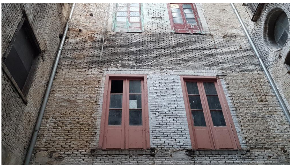
(E17c) Huecos sin protección en planta primera y segunda (h>6 m. h>10 m.).
