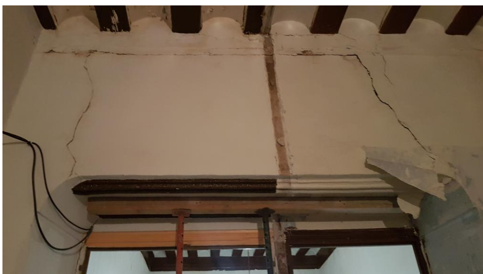
Planta primera (106c). Apeo del dintel de un hueco de paso. Fisuración de la fábrica
