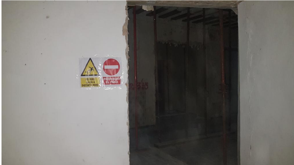
Entreplanta (E23). Nuevos apeos y señalización de peligro
