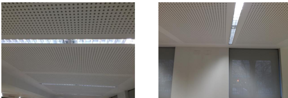
Iluminación fluorescente actual en zona de trabajo
