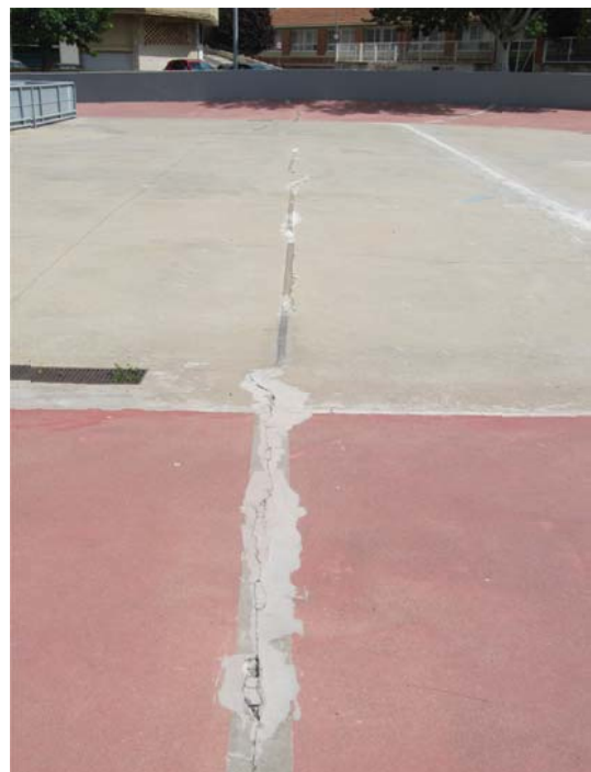
Fisura transversal de pista
