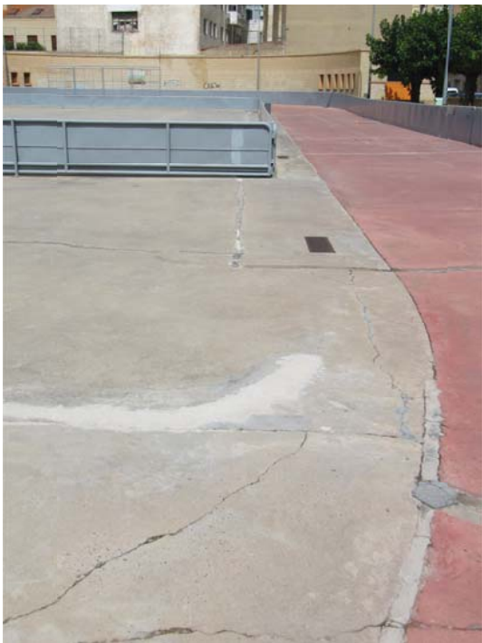
Fisuraciones y reparaciones varias
