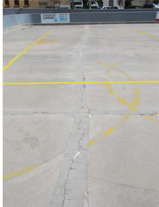
Fisura transversal pista de hockey
