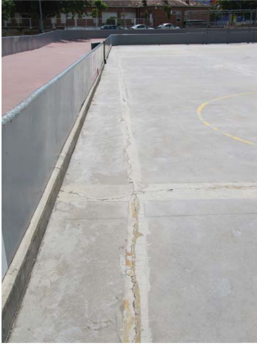
Fisura longitudinal en pista hockey
