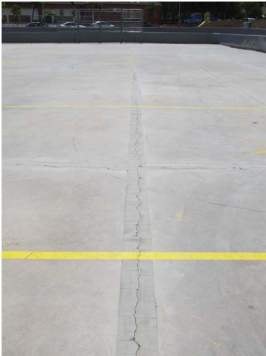
Fisura longitudinal en pista hockey
