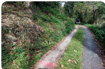
Foto 8. Tramo Pk0+400-Pk0+430 Deslizamiento
