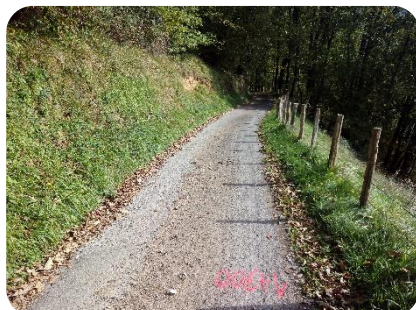
Foto 1.4 Pk1+300 (retroceso) Disgregación
