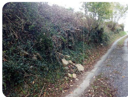
Fot27. Desprendimnto. MI Pk1+275-Pk1+375
