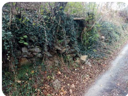
Fot26. Desprendimnto. MI Pk1+275-Pk1+375
