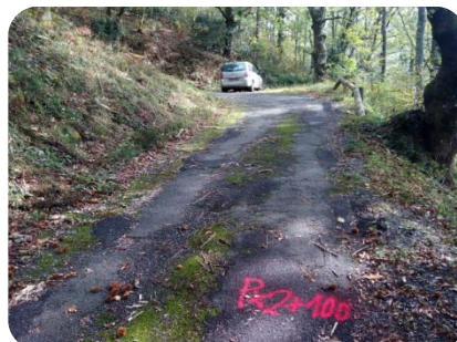
Foto 2.3 Pk2+100 disgregación franja central
