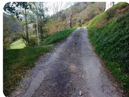
Foto 1.6. Pk1+360 Fallos varios de firme.
