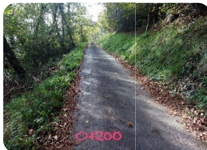
Foto 6. Pk0+200 Tramo fuera estrechamiento
