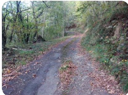
Fot 2.5. Pk1+130. Disgregación zona central
