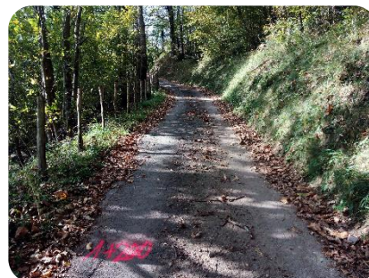
Foto 1.3 Pk1+200 Zona central disgregada
