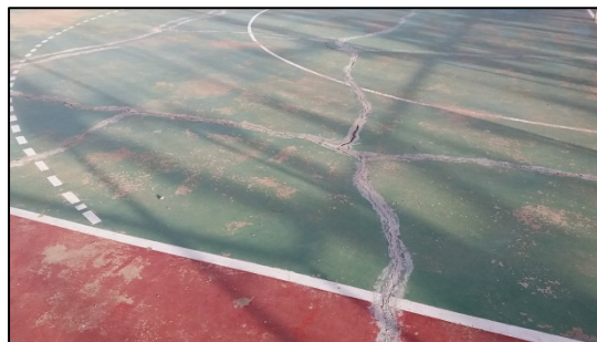
Detalle pista. Grietas profundas
