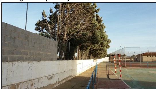
Red de protección inexistente. Gran arbolado
