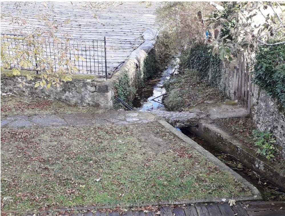
PUNTO DE VERTIDO DEL COLECTOR DE PLUVIALES
