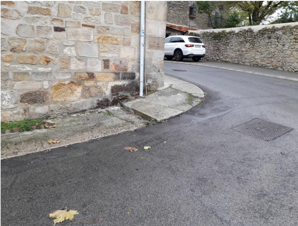
ENTRONQUE DE C/KALUXA CON C/ PORTUKALEA (M. DCHA). ACERA ESTRECHA Y CON ESCALONES
