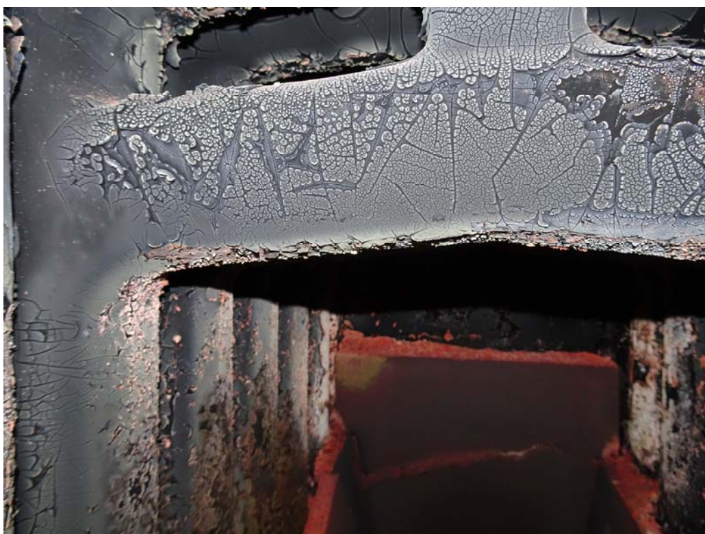
Vista interior de la caldera de ACS
