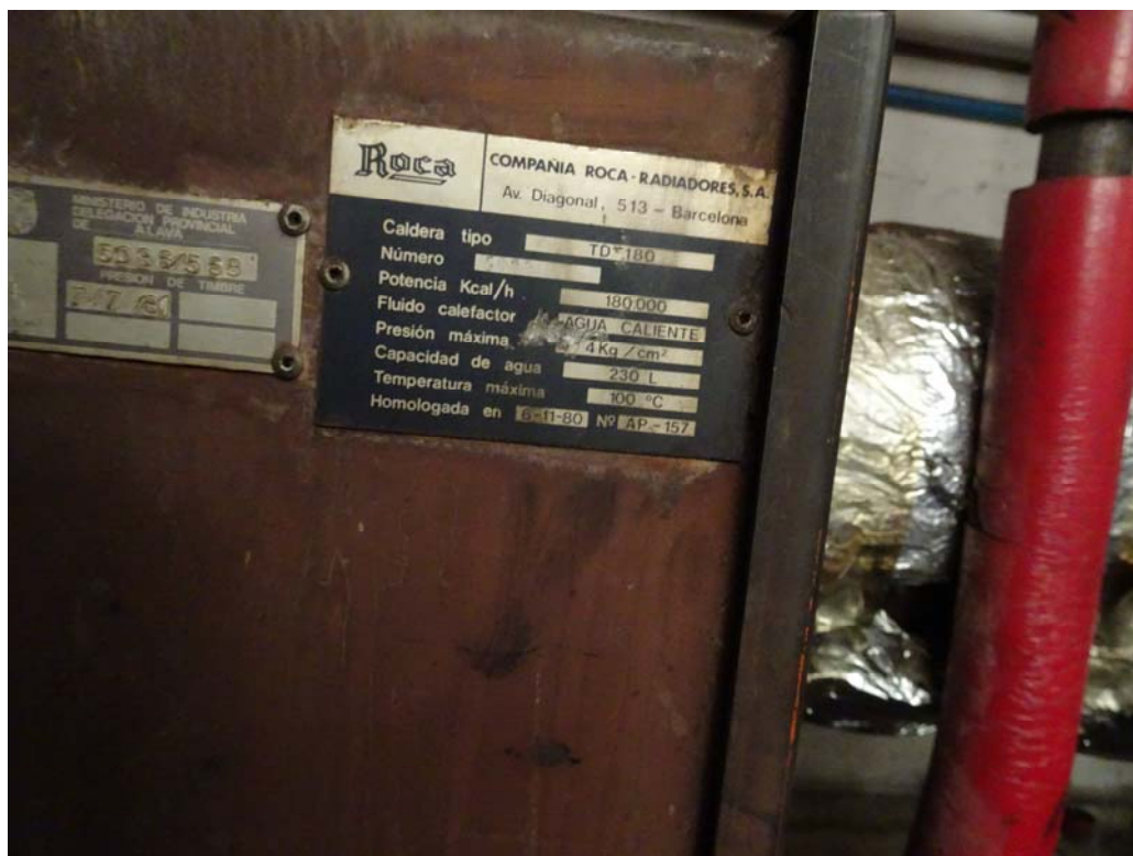
Placa de fabricación y características de la caldera de calefacción
