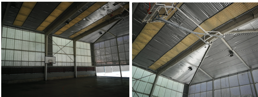
Efecto de la entrada de palomas: abombamiento chapa
