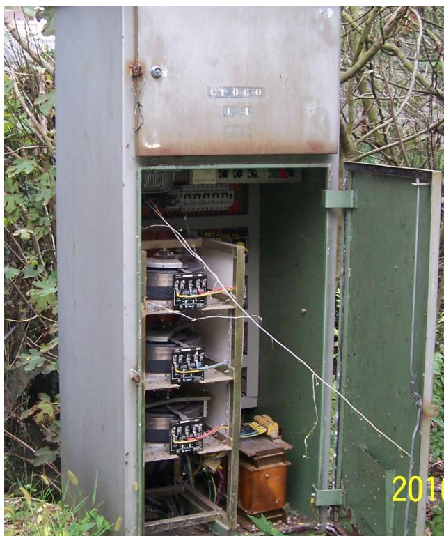
Fotografía: 2 Centro de mando 2
