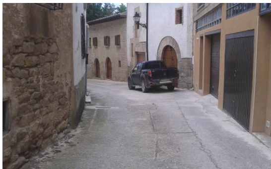
Imagen 1: Comienzo del tramo a renovar en Calle Correo. Grietas en el pavimento.
