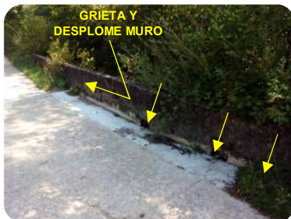
Foto 5. Pk0+030 MD. Ventanas en murete
