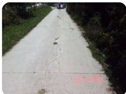
Foto 21. Pk2+000 Inicio nuevo tramo de fisuración previo acceso granja.
