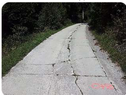
Fot 5. Pk0+040 Nueva zona fisuración transv.
