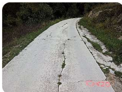
Foto 3. Pk0+020 Inicio restos de cuneta HOR
