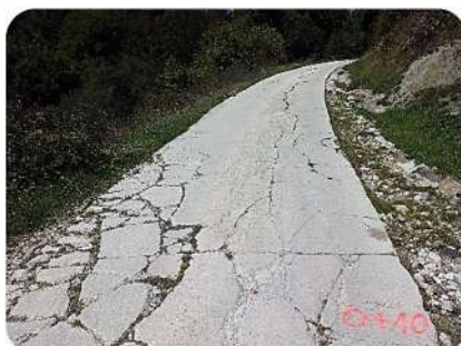
Foto 2. Pk0+010 Fisuración y pérdida cuneta
