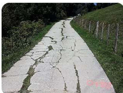
Foto 11. Pk0+100 Agua bajo losas al pasar
