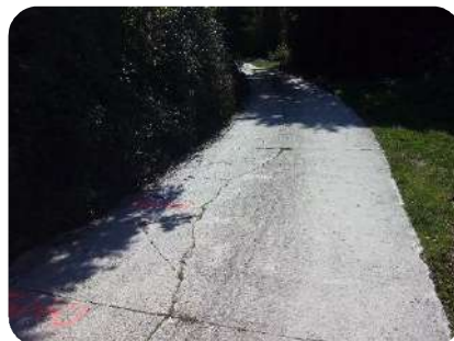
F20. Pk0+192 Final paños fisurado (retroceso)
