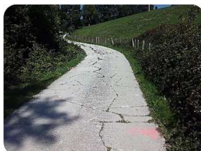
Foto 9. Pk0+080 Inicio tramo mayor fisuración
