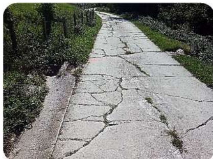
Foto 16. ODT del Pk0+151 (retroceso)
