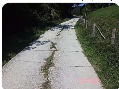
Foto 13. Pk0+120 Nuevo tramo alta fisuración
