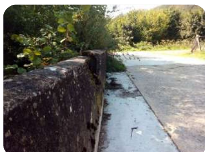
Foto 13. Pk0+030 Desplome murete lado MD.
