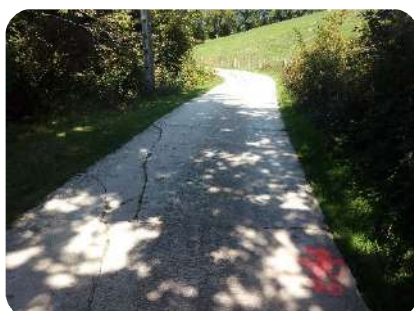
Foto 8. Pk0+070 Fisuración en MI del camino
