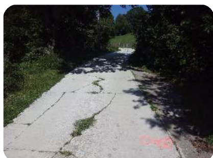
Foto 7. Pk0+060 Fisuración en MI del camino
