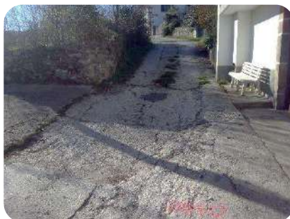
Foto 5. Pk0+060 (retroceso). Fachada nº60
