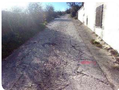
Foto 2. Pk0+020 (retroceso). Fachada nº35
