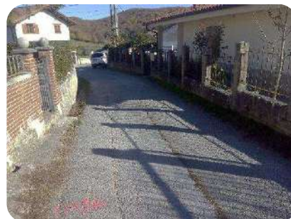
Foto 12. Pk0+130. Tramo nº68 (MI) nº70 (MD)
