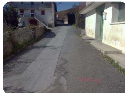
Foto 9. Pk0+220 (retroceso) Fachada nº33
