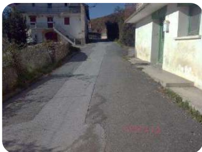
Foto 19. Pk0+220 (retroceso) Fachada nº33
