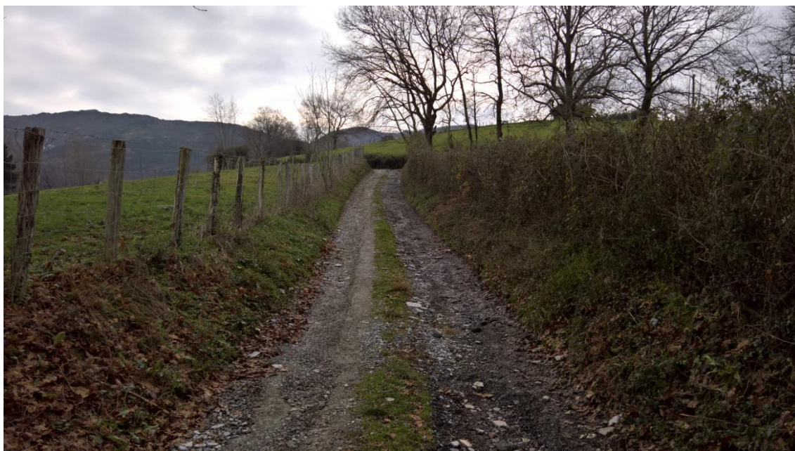
FOTOGRAFÍA 4: Superficie de rodadura con grandes roderas
