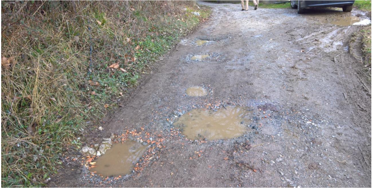
FOTOGRAFÍA 1: Superficie irregular, bacheada y deslizante.
