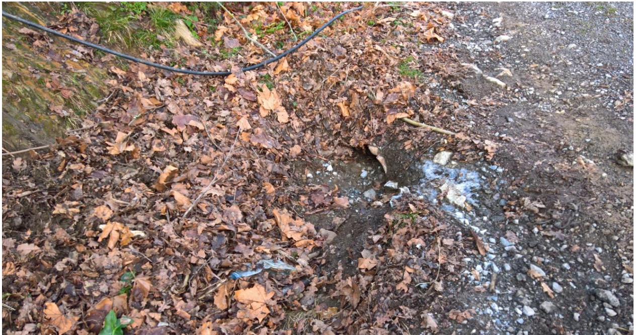
FOTOGRAFÍA 2: Actual caño totalmente atascado.
