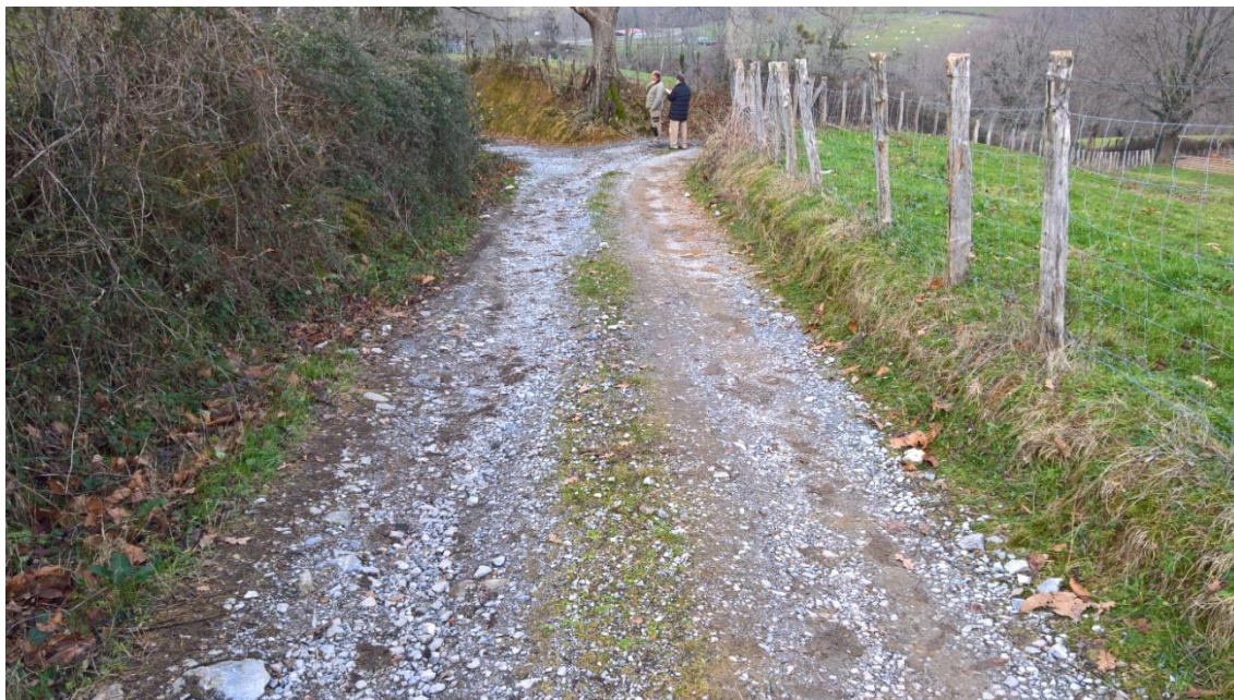
FOTOGRAFÍA 3: Tramo de camino sin cunetas longitudinales
