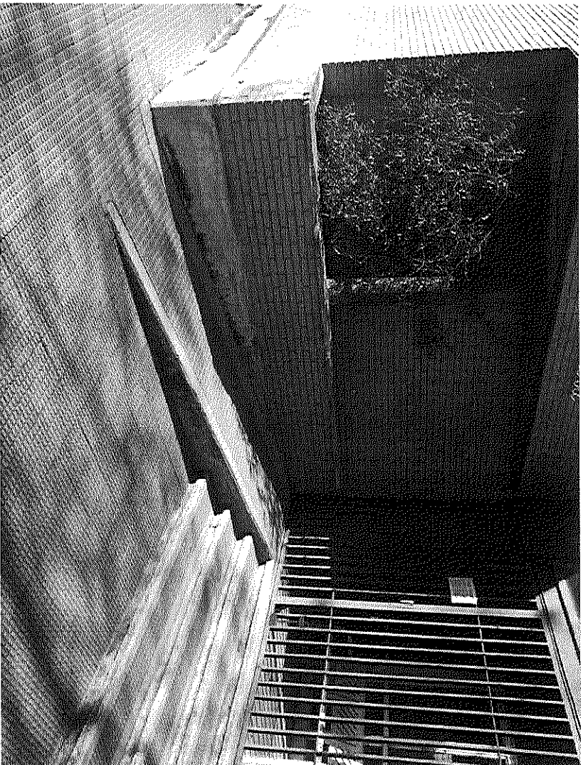
Rampa existente, con una anchura insuficiente y una pendiente excesiva, no sirviendo como itinerario accesible. Fijese la ubicación de la reja, no existiendo descansillo en el desembarco de la rampa.
