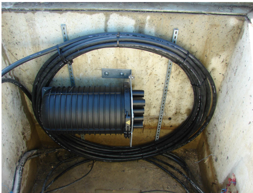
Detalle de torpedo en el interior de la valona de cables
