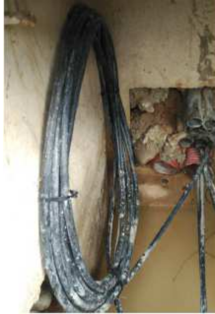
Figura 30. Detalle de arqueta de registro con reserva de cable
