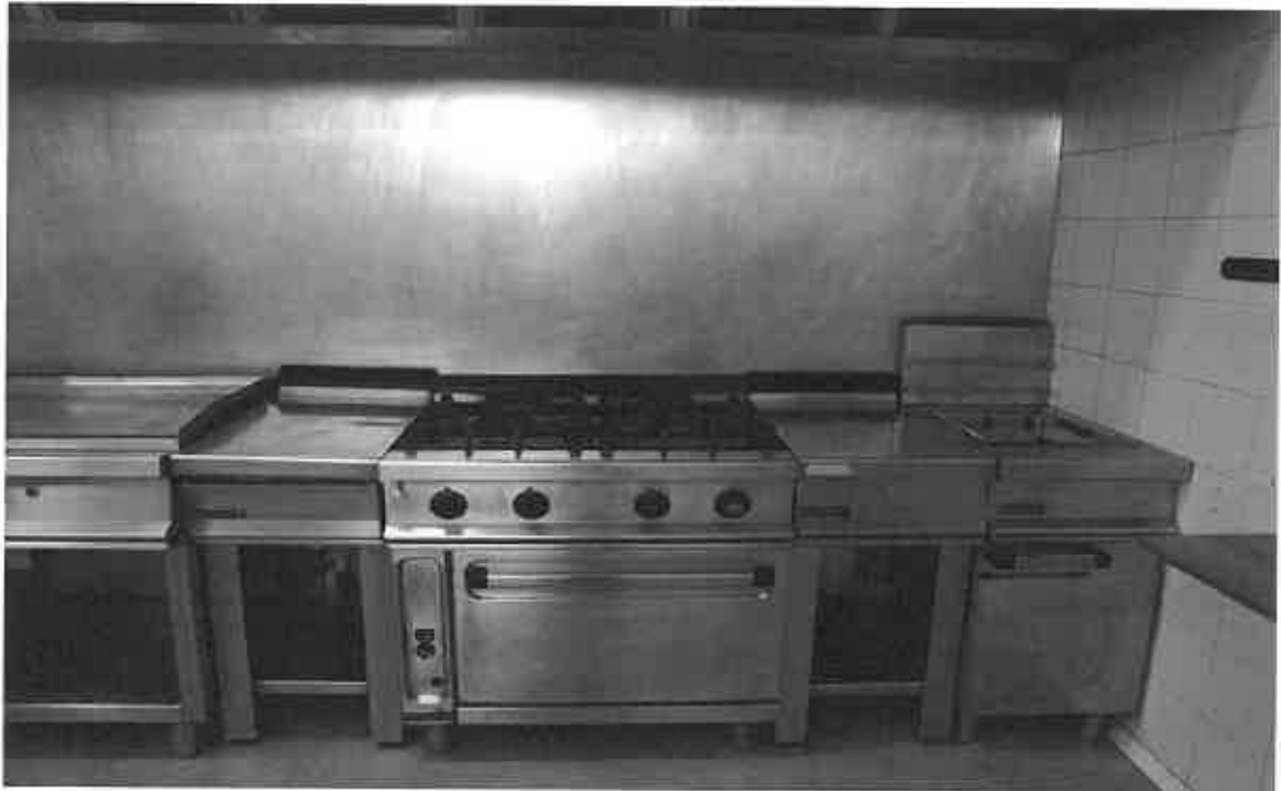
- cocina industrial, modelo C-741, marca REPAGAS - mesas de apoyo, modelo M-47, marca REPAGAS -
