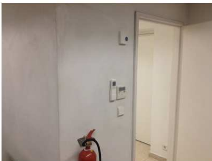
Fig. 6 - Elementos de control y eléctricos a trasladar
