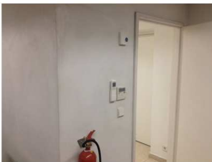
Fig. 6 - Elementos de control y eléctricos a trasladar
