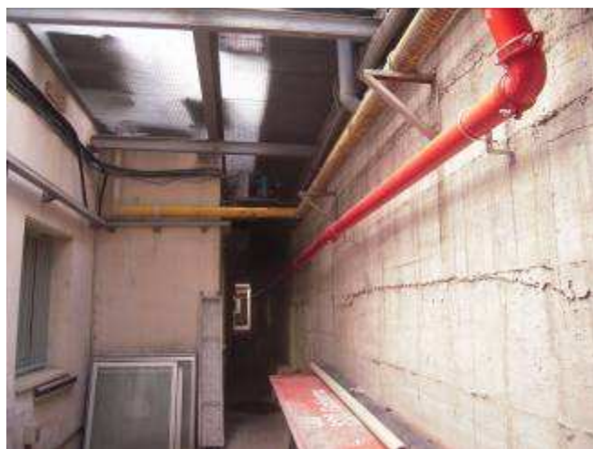
Foto 5: Patio inglés: conducciones de abastecimiento de agua y gas
