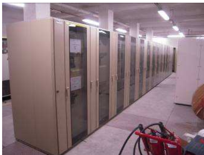
Foto 6: Cuadros generales de distribución
