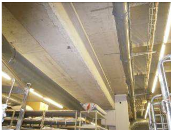
Foto 4: Descuelgue de viga de hormigón en zona de almacén de lencería
