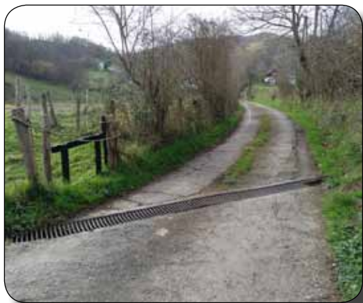
Primera parrilla que deriva la escorrentía superficial y el caudal procedente de la cuneta
