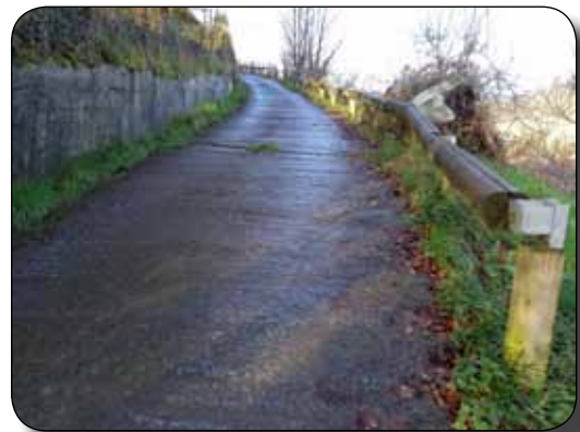
Barrera de protección en curva de fuerte pendiente
