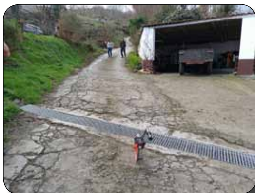
Segunda parrilla y tramo muy dañado a continuación
