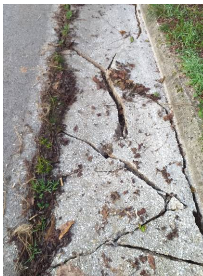
Estado de la cuneta
