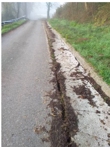
Estado de la cuneta
