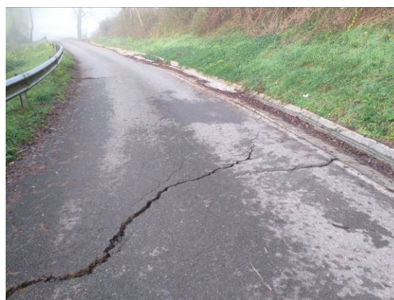
Grietas en pavimento
