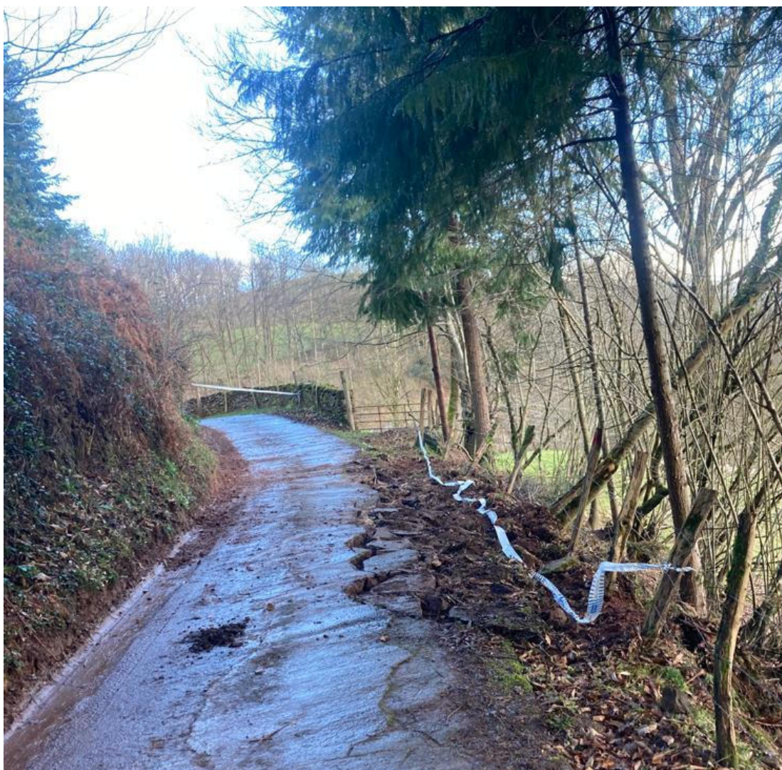
Fotografía2 del terraplén deslizado y pavimento agrietado en el camino
