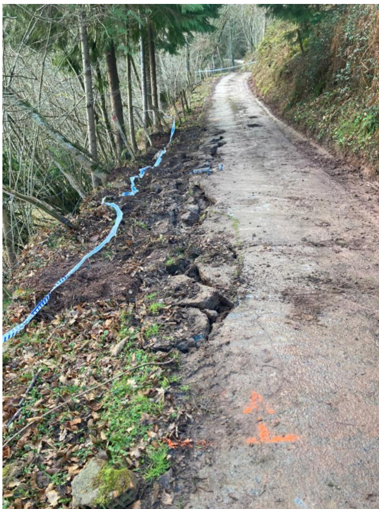
Fotografía1 del terraplén deslizado y pavimento agrietado en el camino Artxeke Borda
