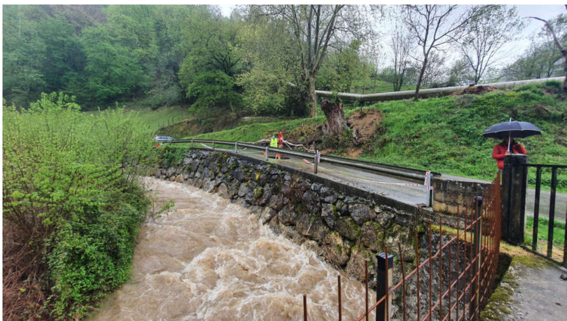
Fotografía1 muro de escollera con el trasdós erosionado afectando al camino Arbuz
