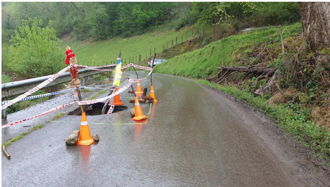
Fotografía4 socavón en el camino Arbuz
