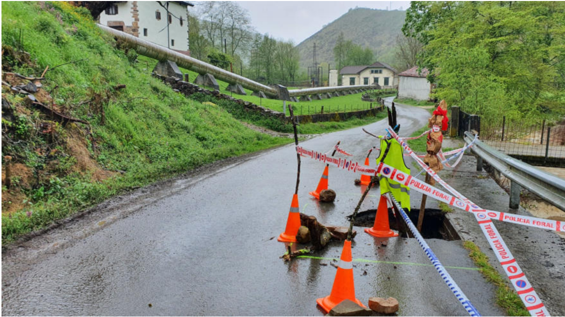
Fotografía2 socavón en el camino Arbuz
